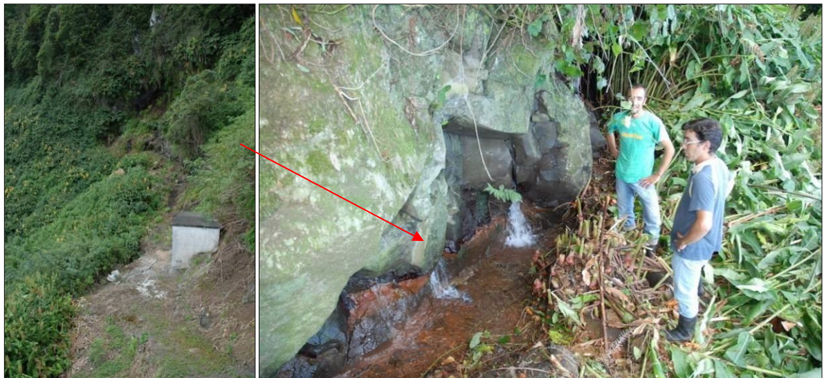
Figura 2.9.34 | Presença de blocos rochosos individualizados no talude e na sua base, próximos de uma nascente. A seta indica a presença de bloco rochoso oriundo do talude sobranceiro.
