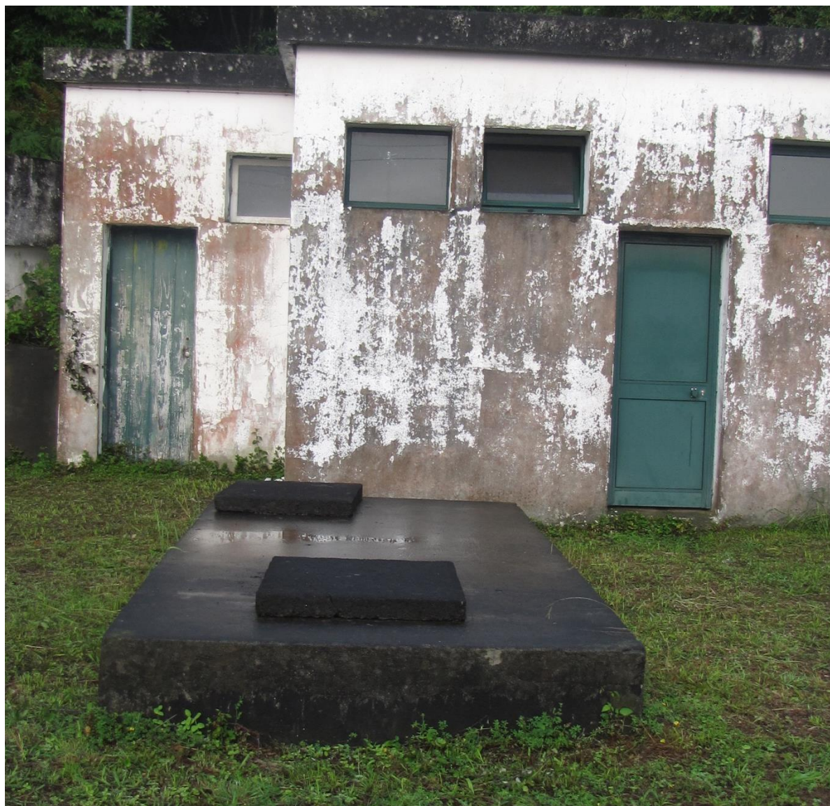
Vista geral do ponto de água.
