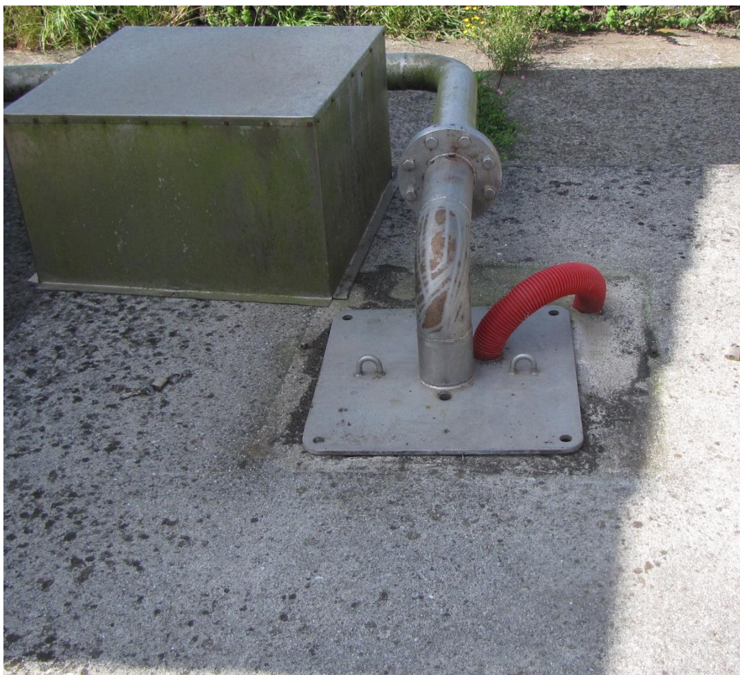
Pormenor do ponto de água.
