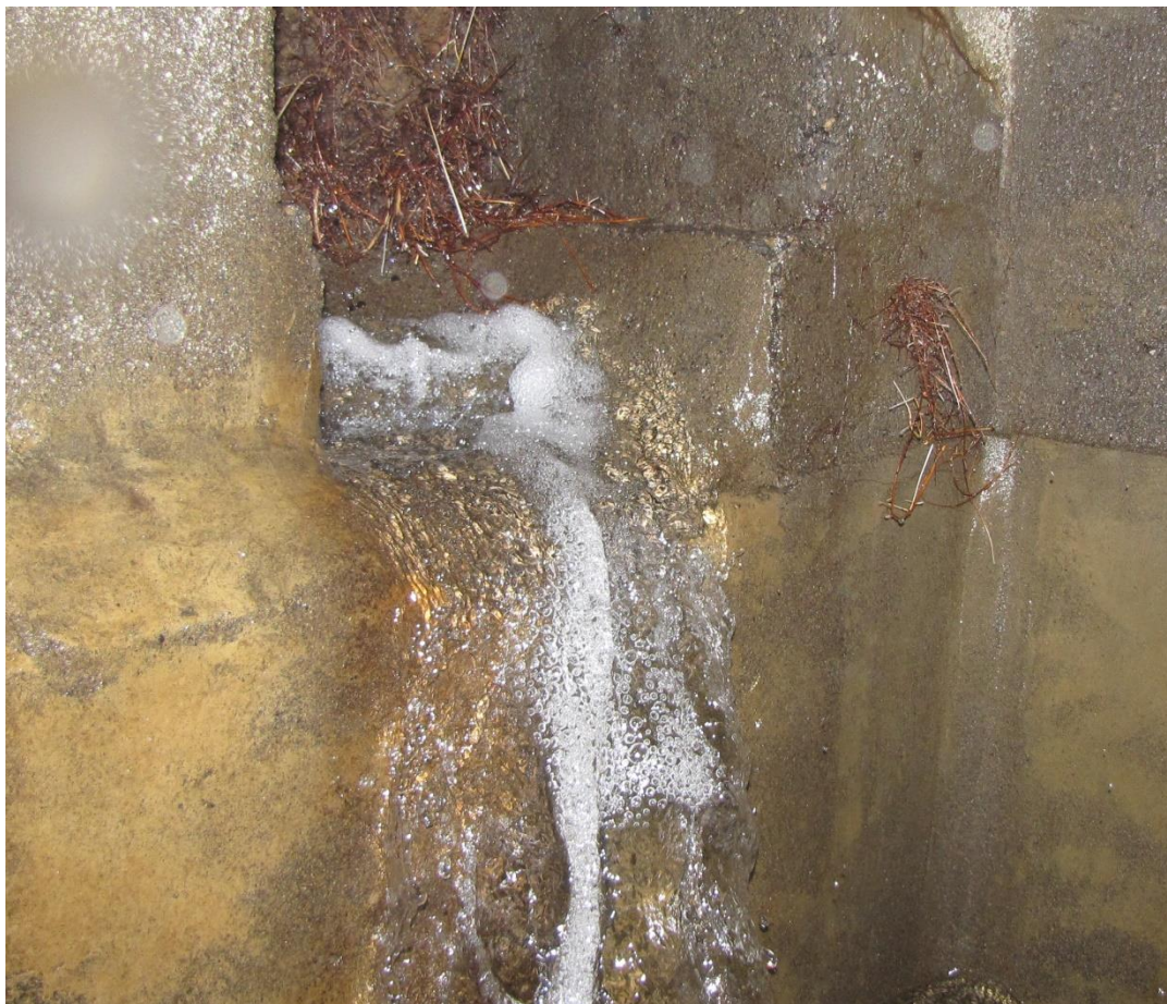
Pormenor do ponto de água.
