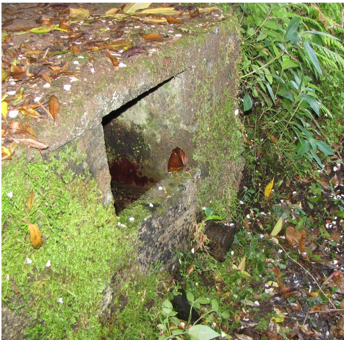
Vista geral do ponto de água.
