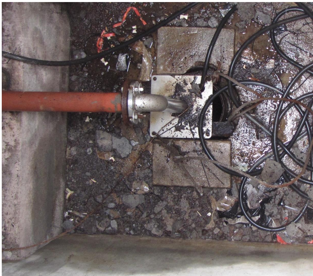
Pormenor do ponto de água.
