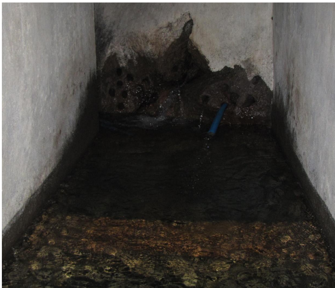
Pormenor do ponto de água.
