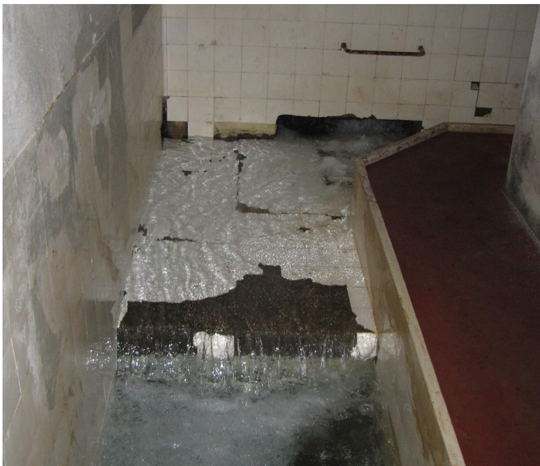
Pormenor do ponto de água.
