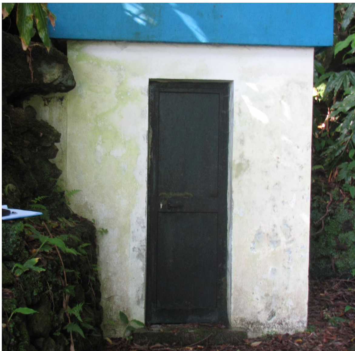
Vista geral do ponto de água.
