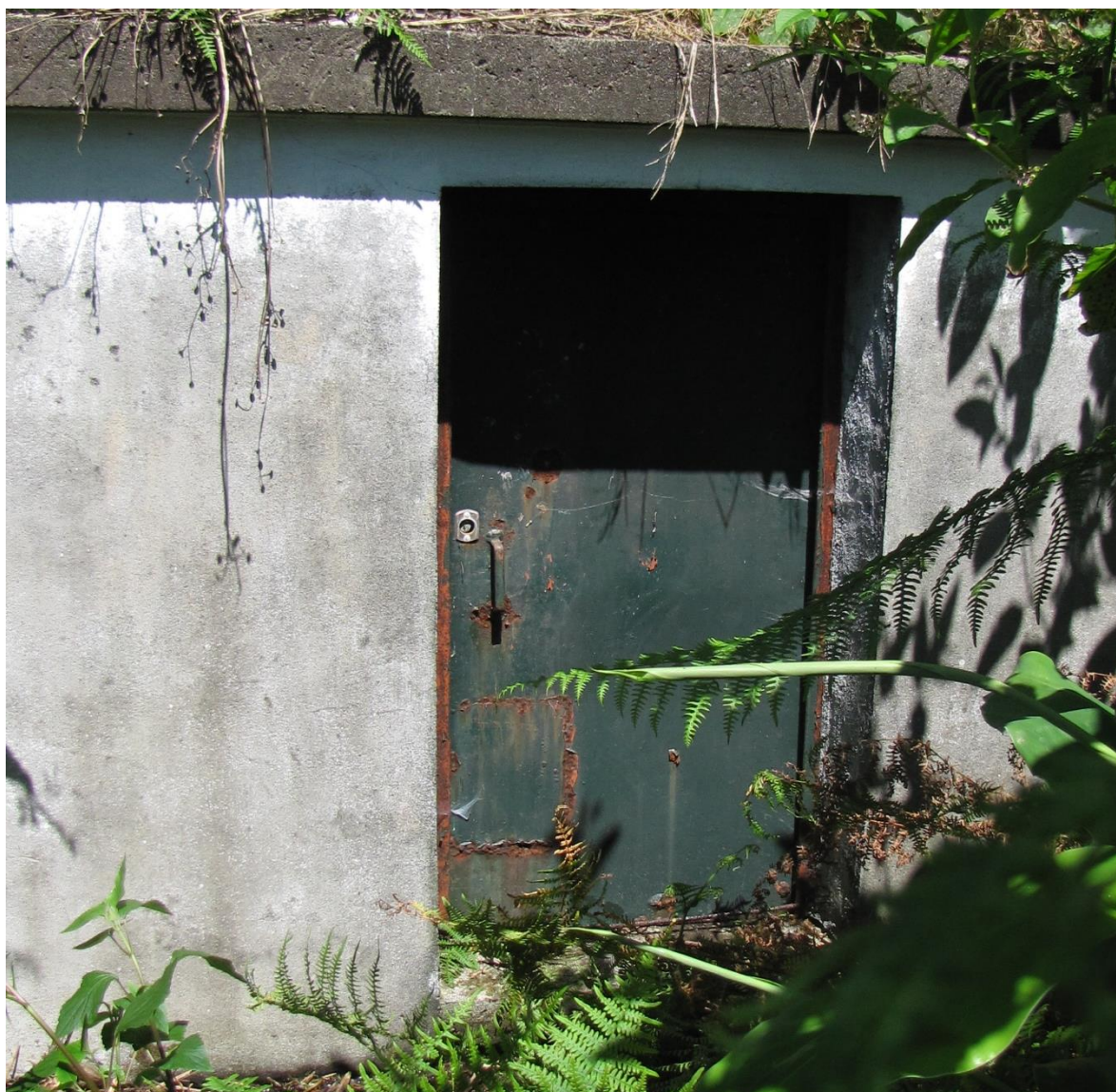
Vista geral do ponto de água.
