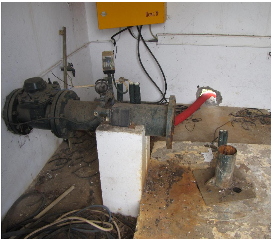
Pormenor do ponto de água.
