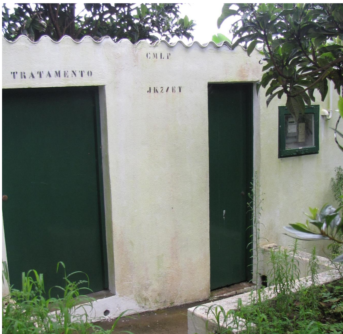
Vista geral do ponto de água.
