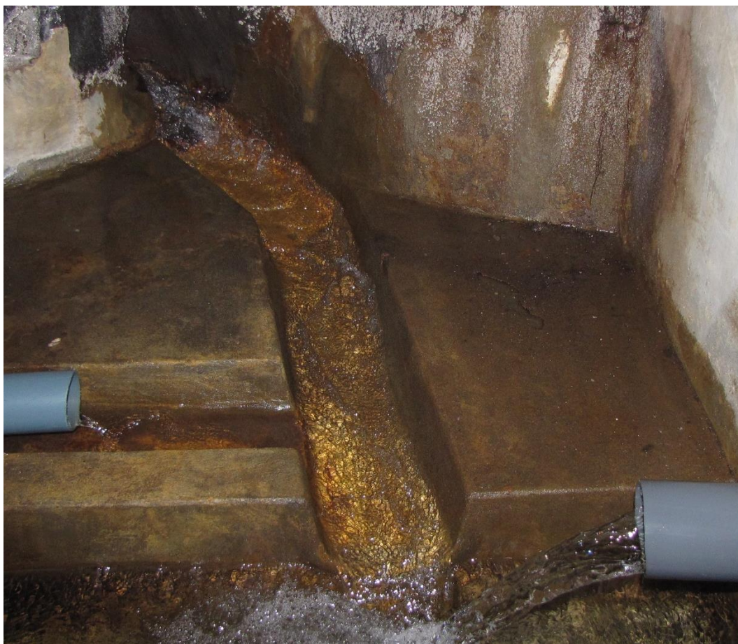
Pormenor do ponto de água.
