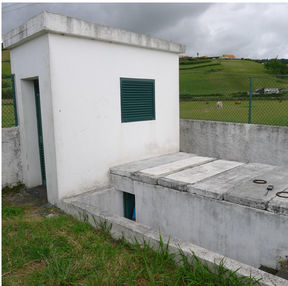
Vista geral do ponto de água.
