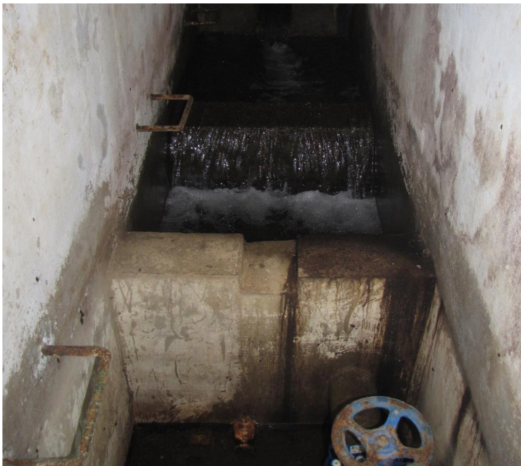
Pormenor do ponto de água.
