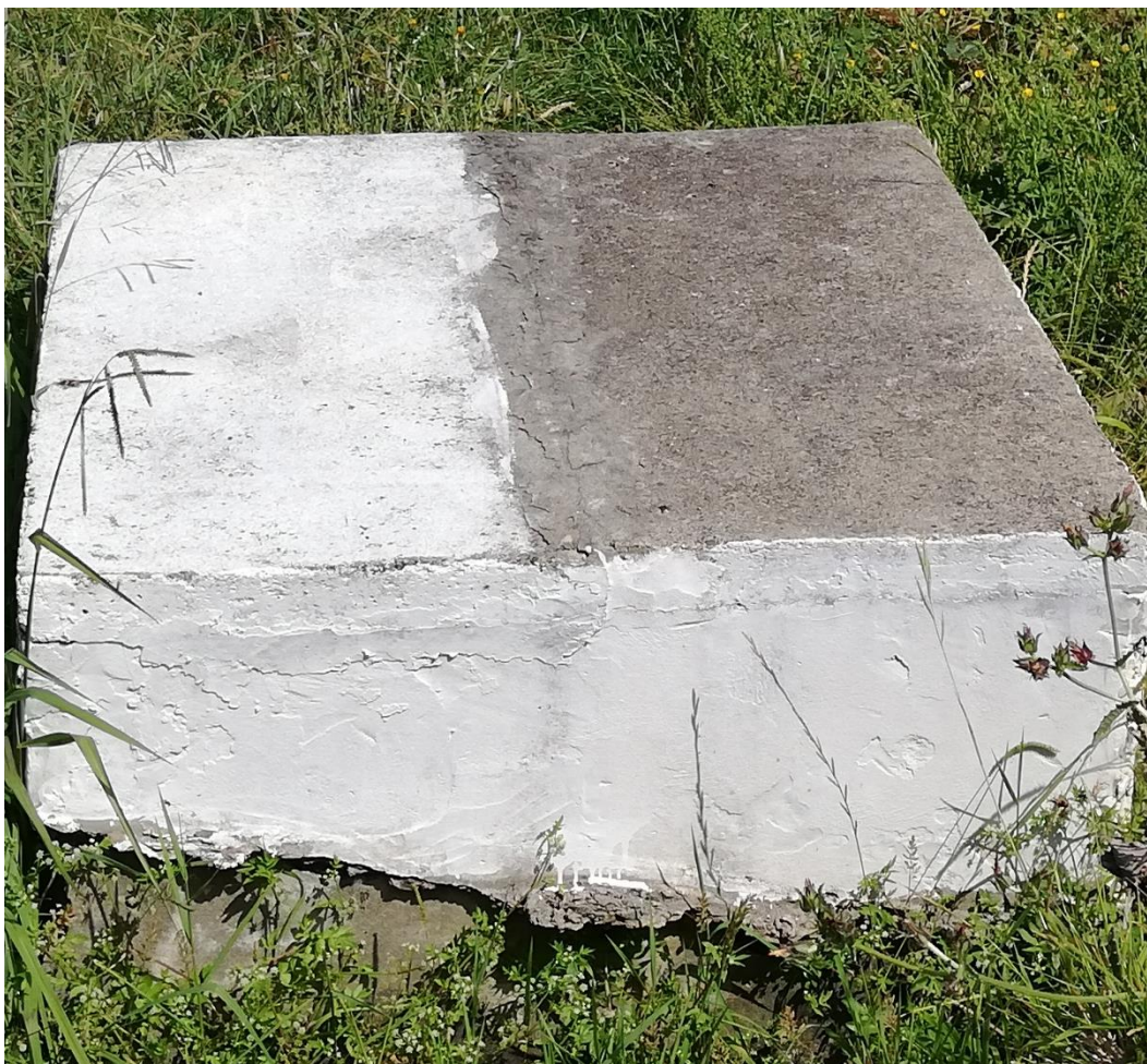
Pormenor do ponto de água.
