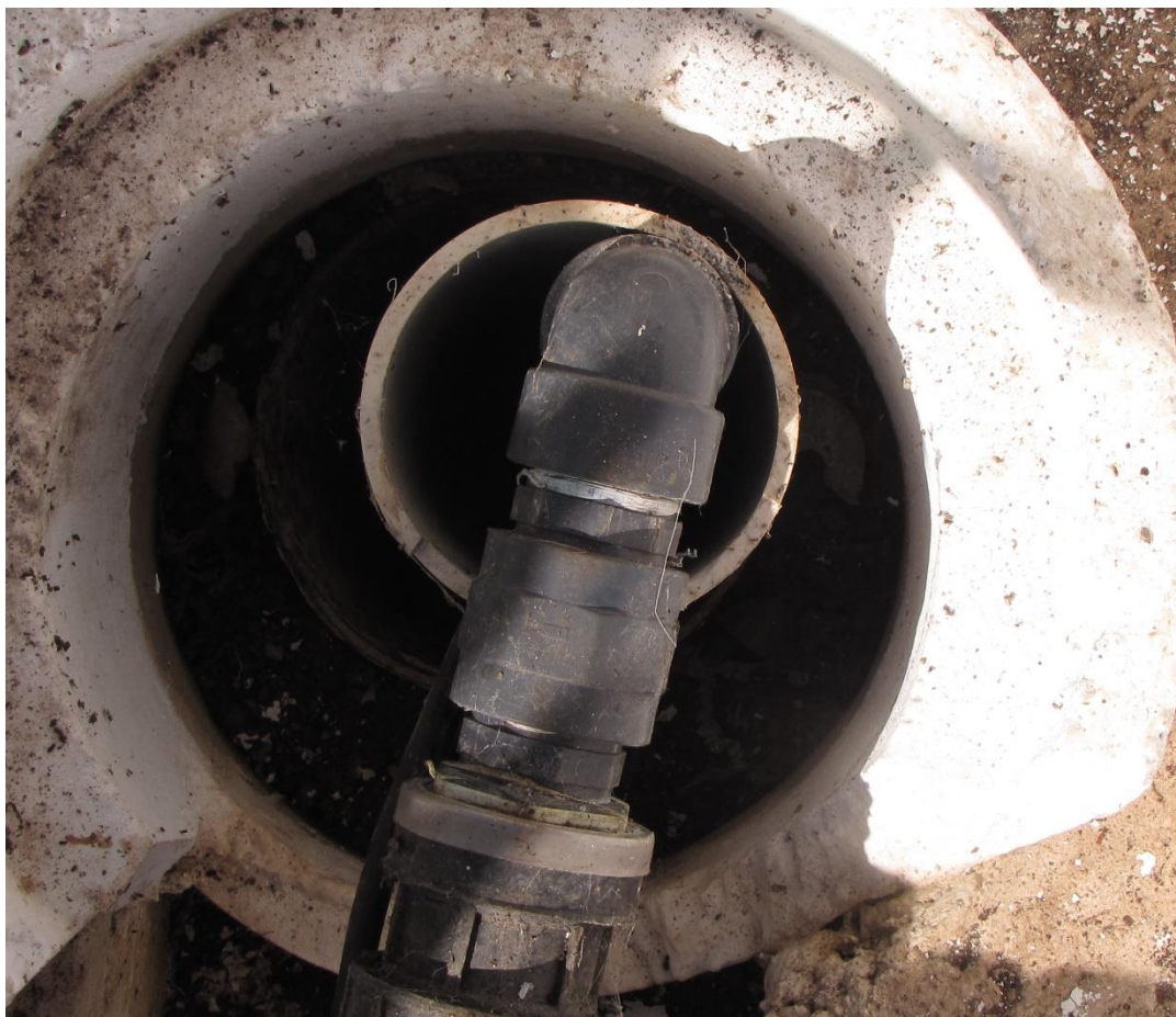
Pormenor do ponto de água.
