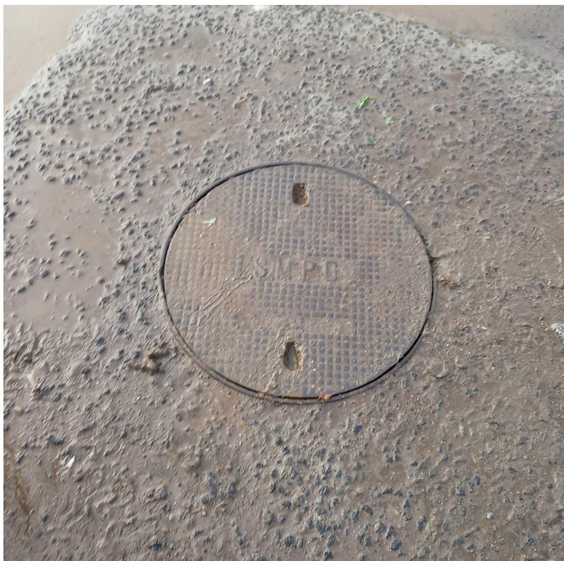
Vista geral do ponto de água.
