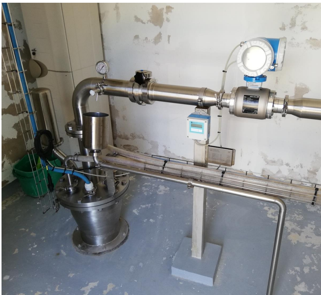
Pormenor do ponto de água.
