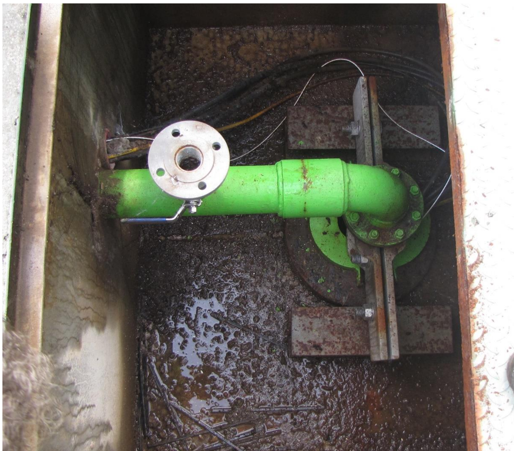
Pormenor do ponto de água.
