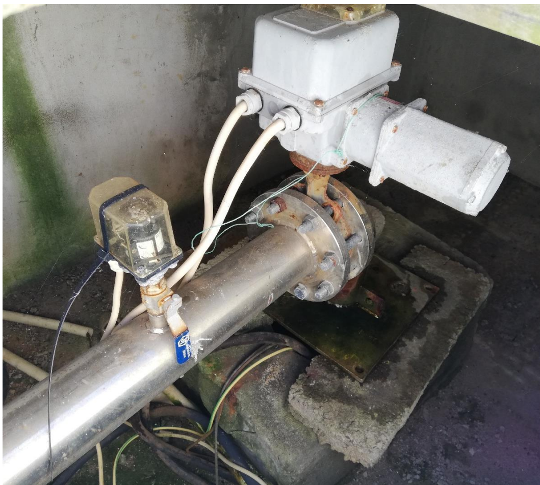
Pormenor do ponto de água.
