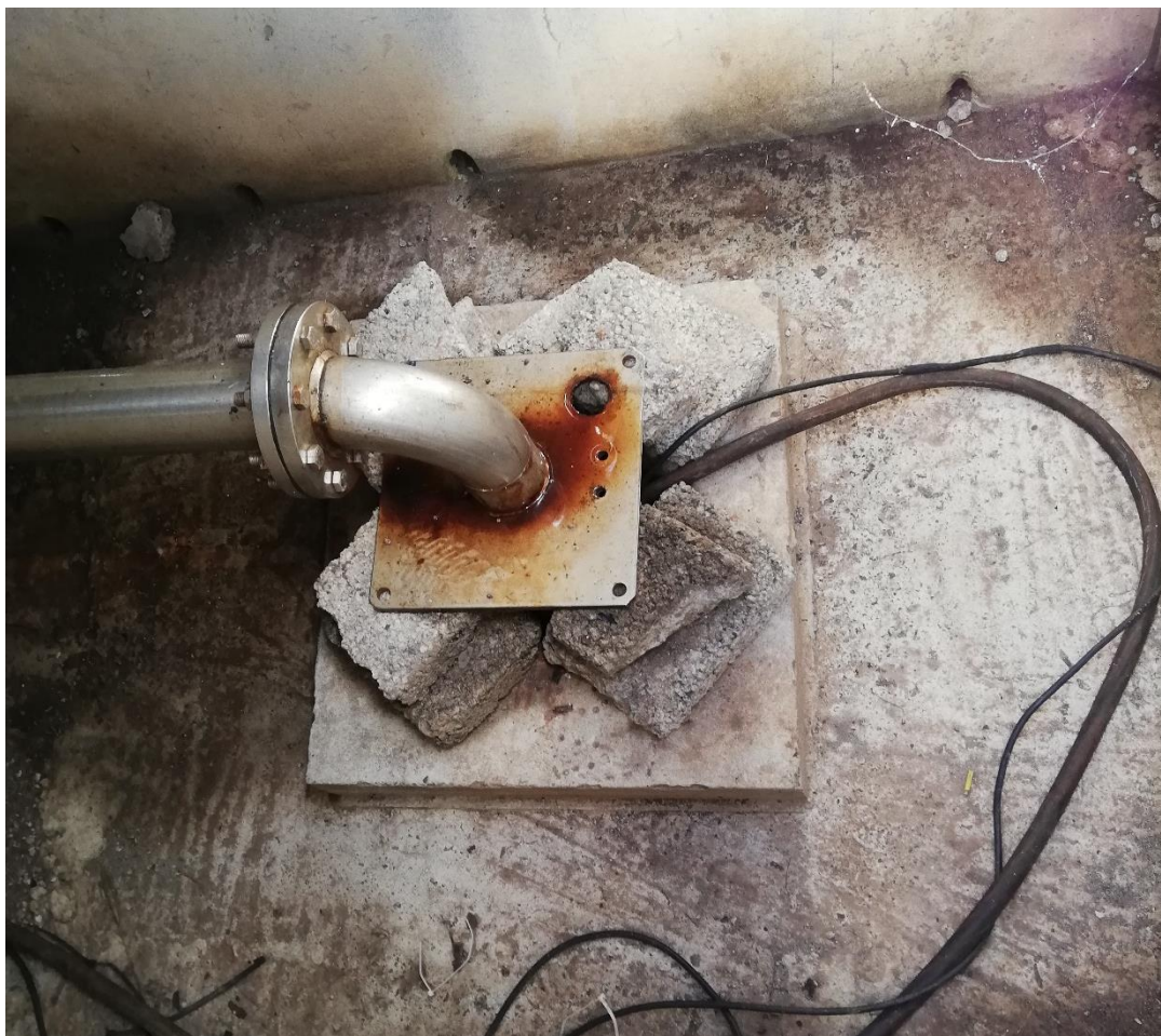
Pormenor do ponto de água.
