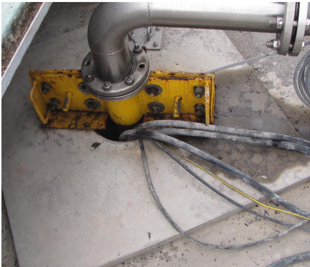
Pormenor do ponto de água.
