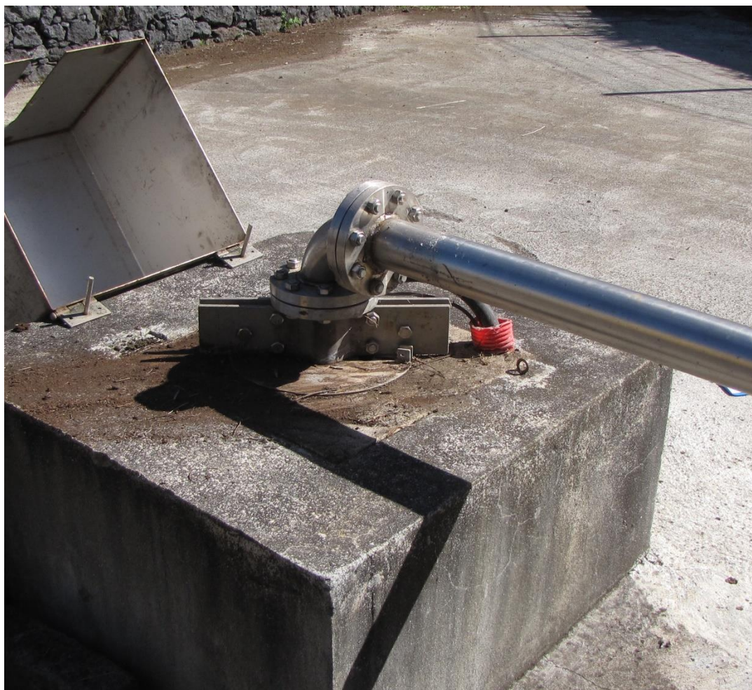
Pormenor do ponto de água.
