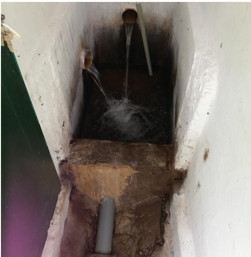
Pormenor do ponto de água.
