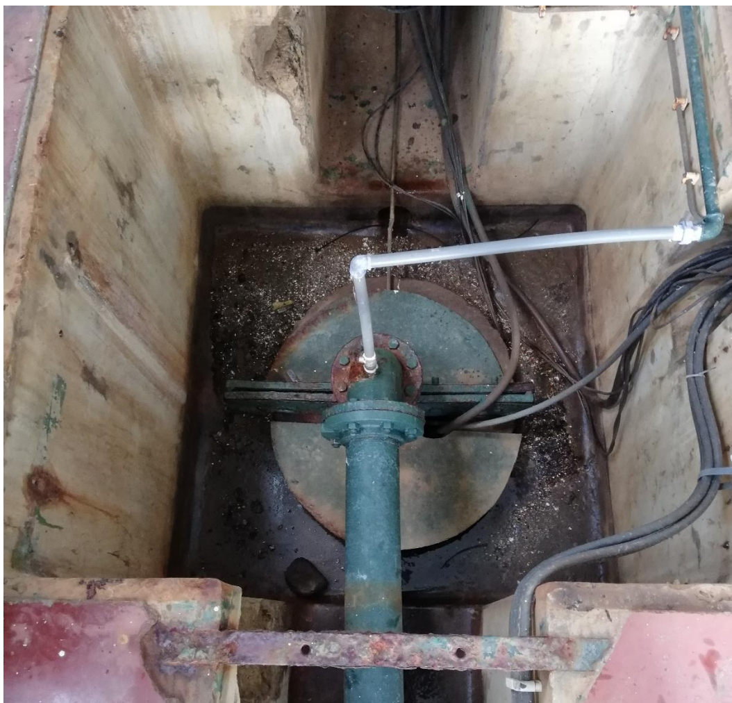
Pormenor do ponto de água.
