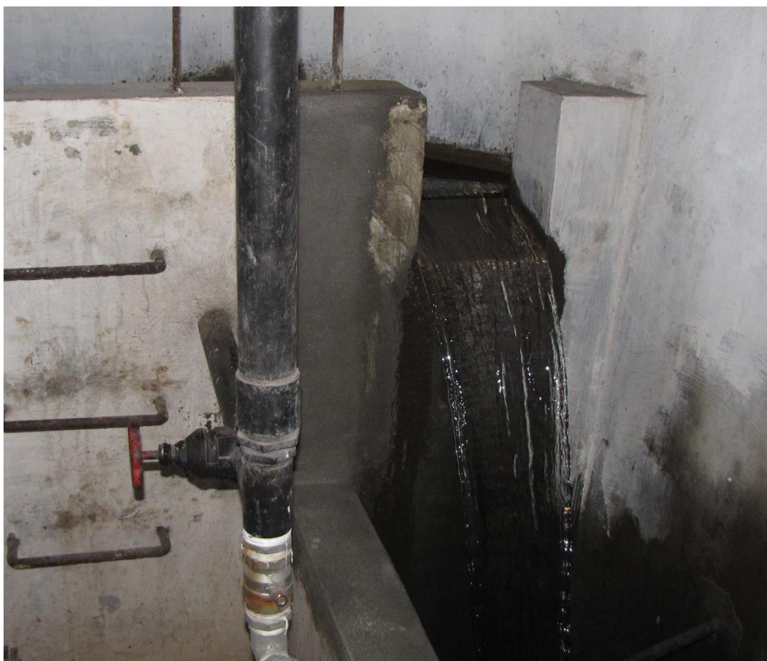
Pormenor do ponto de água.
