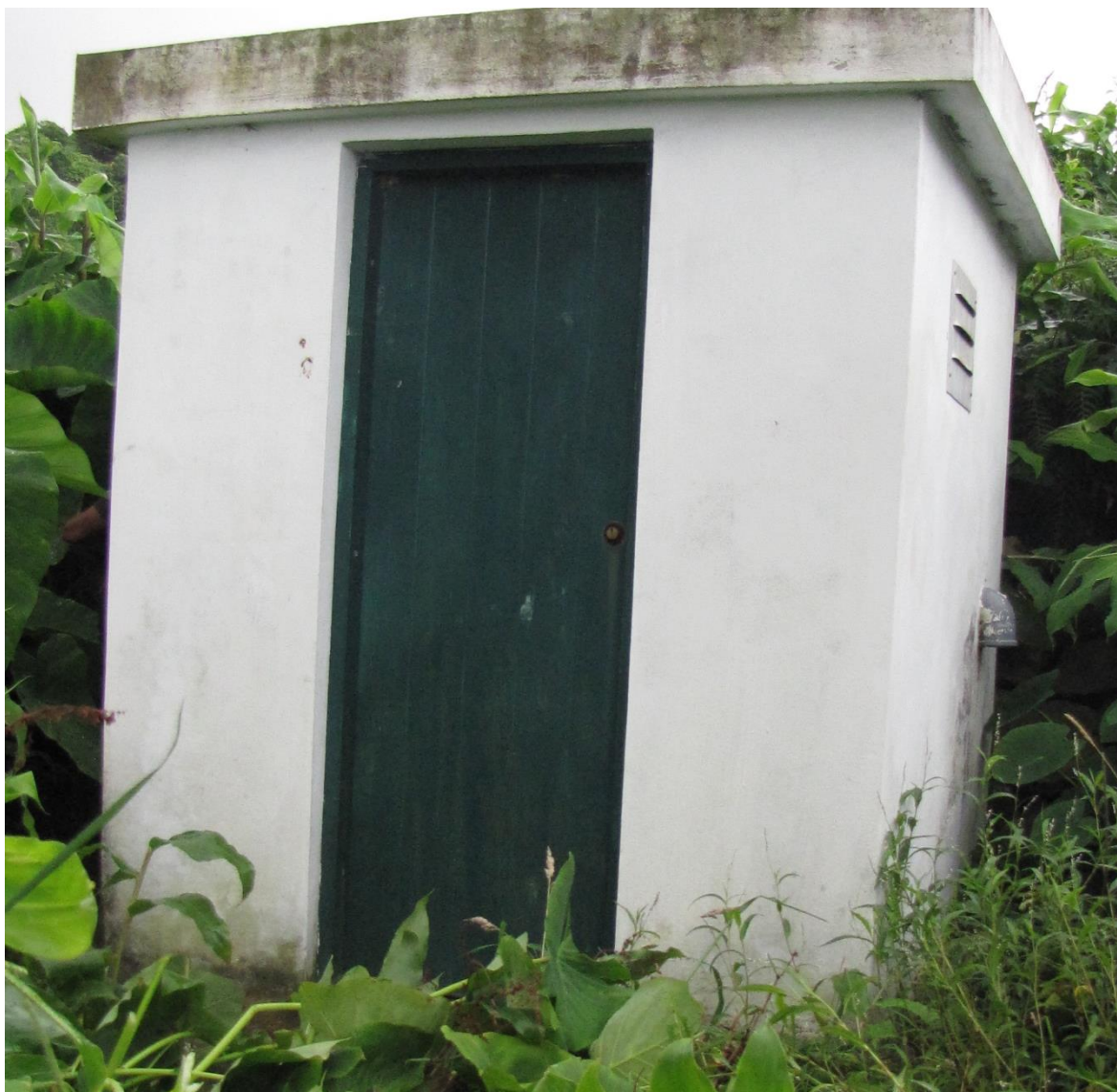
Vista geral do ponto de água.
