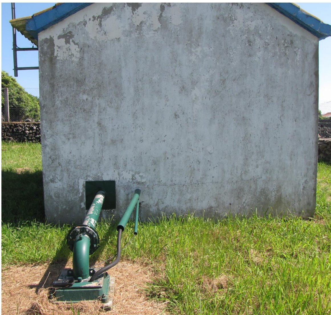
Vista geral do ponto de água.
