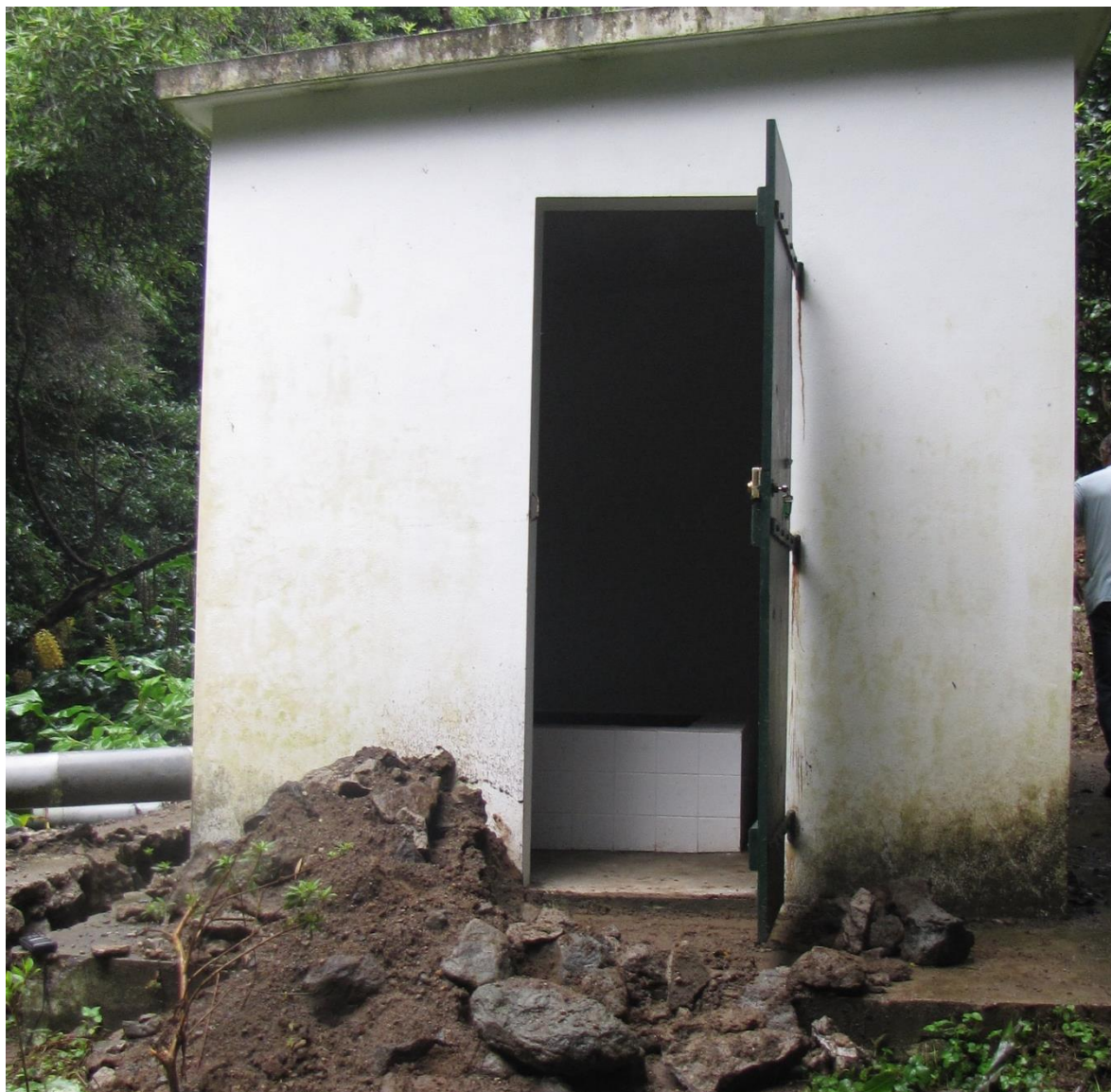
Vista geral do ponto de água.
