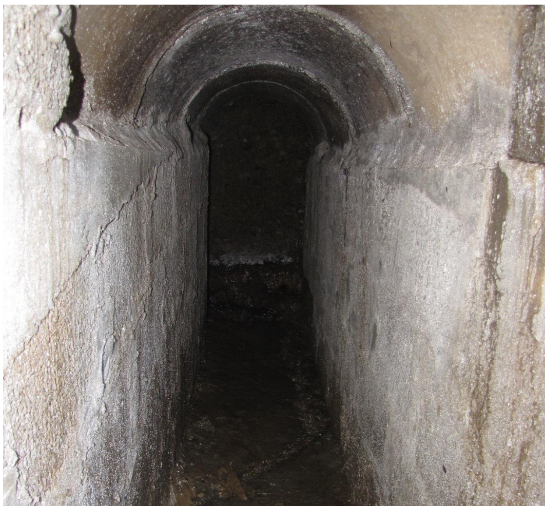
Pormenor do ponto de água.
