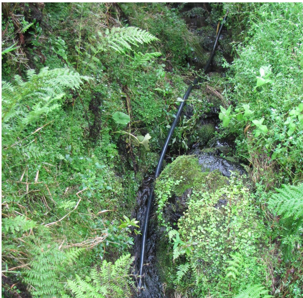
Vista geral do ponto de água.
