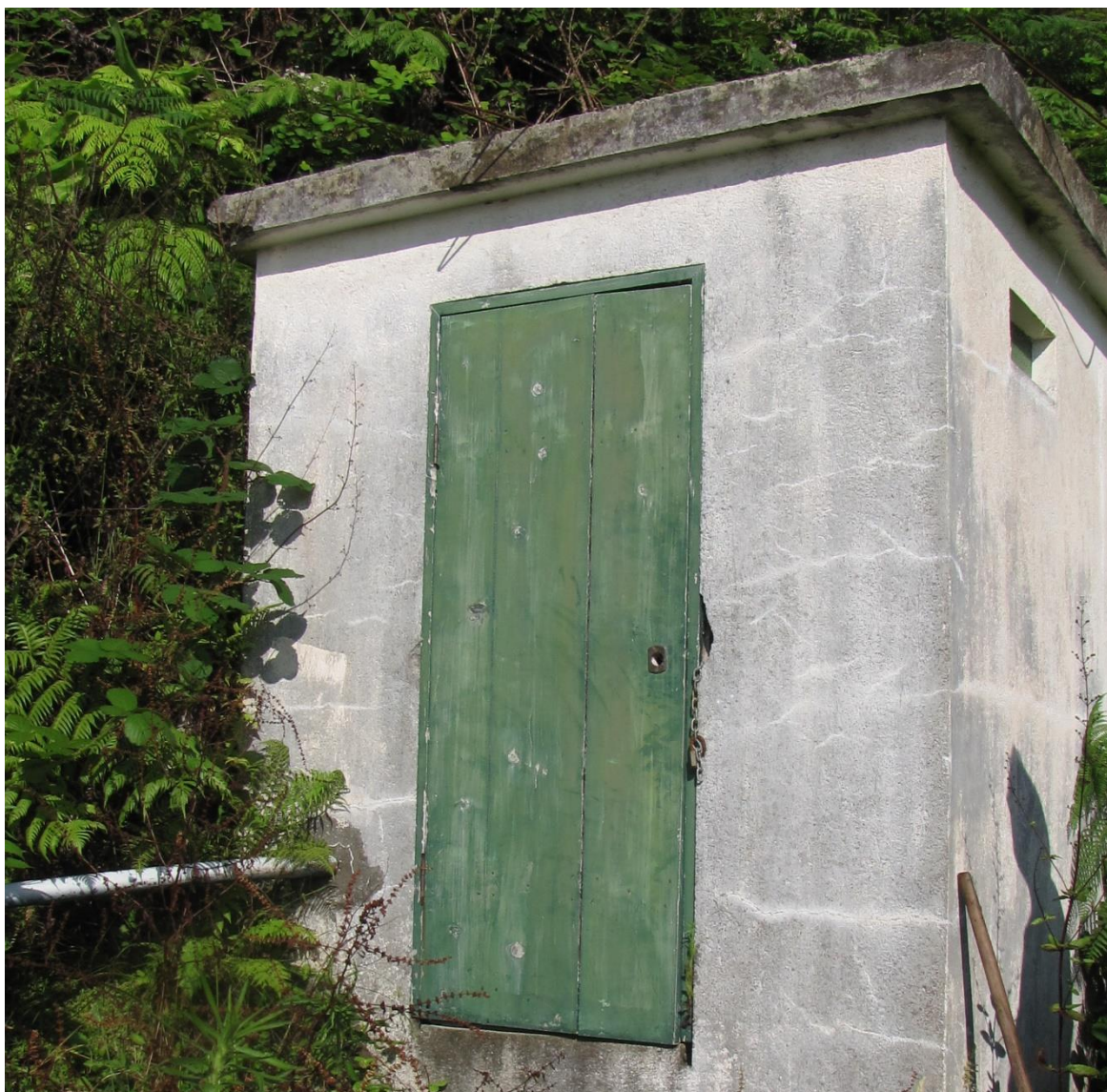
Vista geral do ponto de água.
