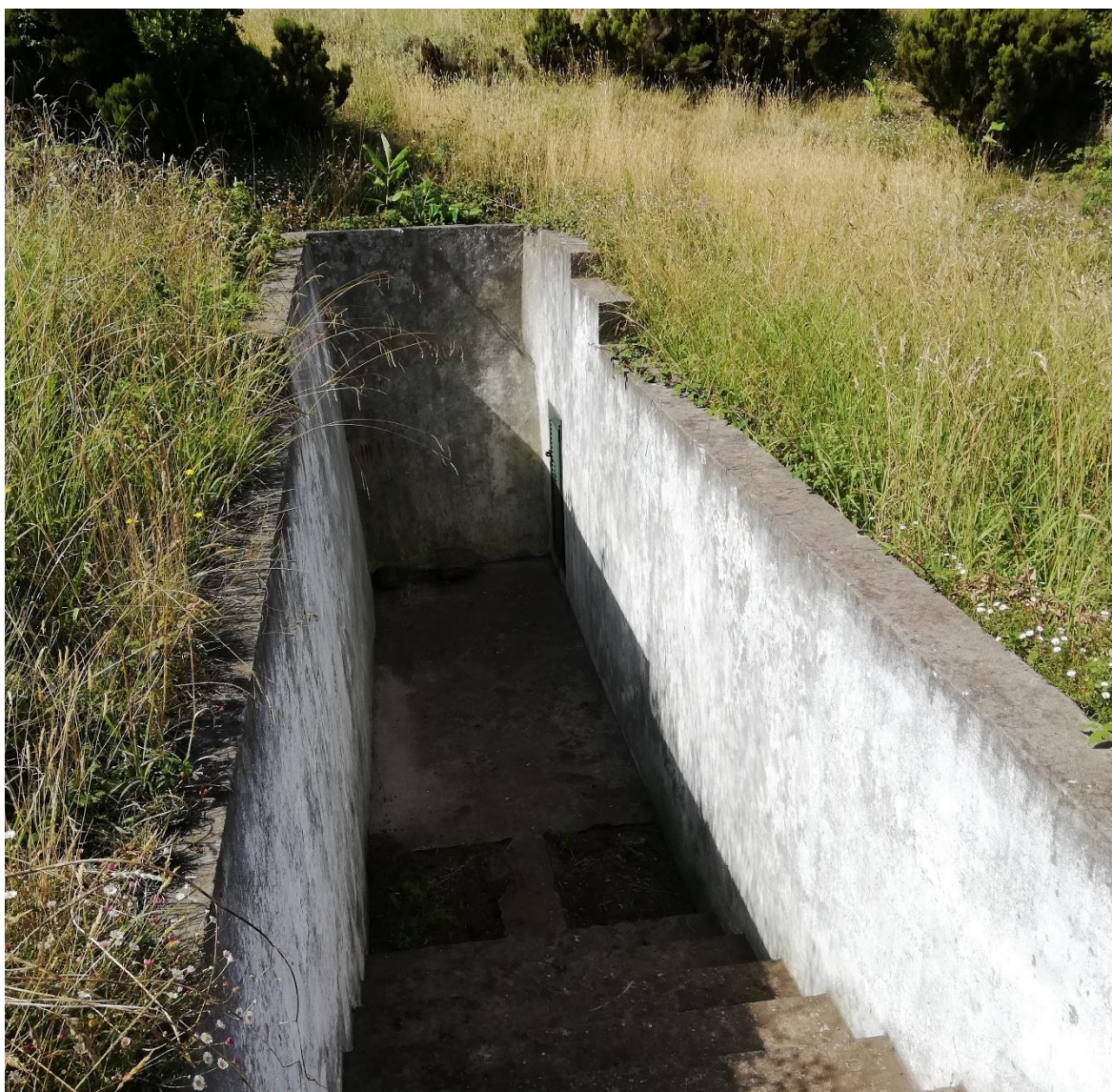
Vista geral do ponto de água.
