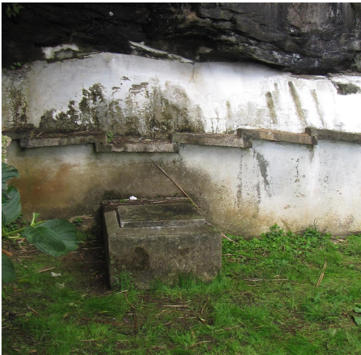
Vista geral do ponto de água.
