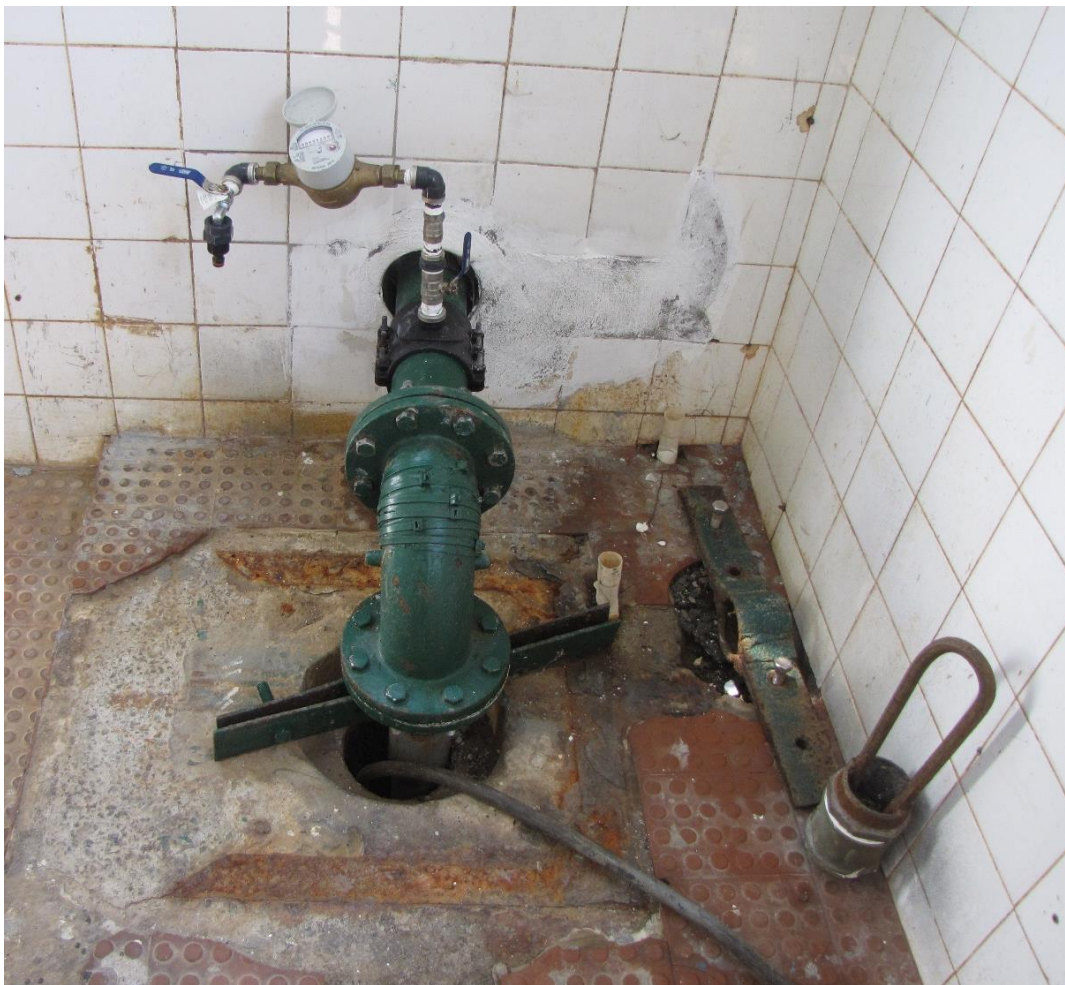
Pormenor do ponto de água.
