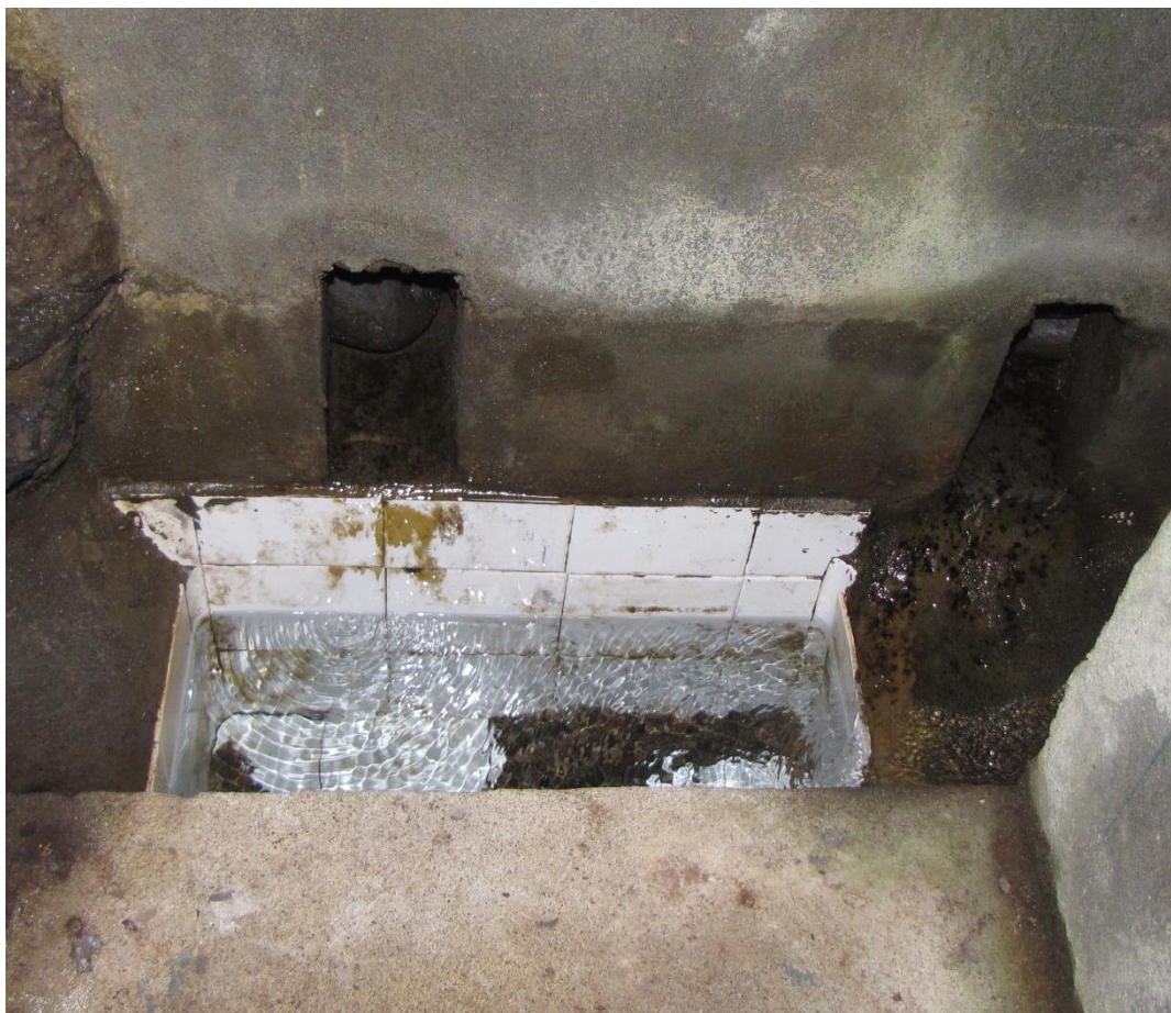
Pormenor do ponto de água.
