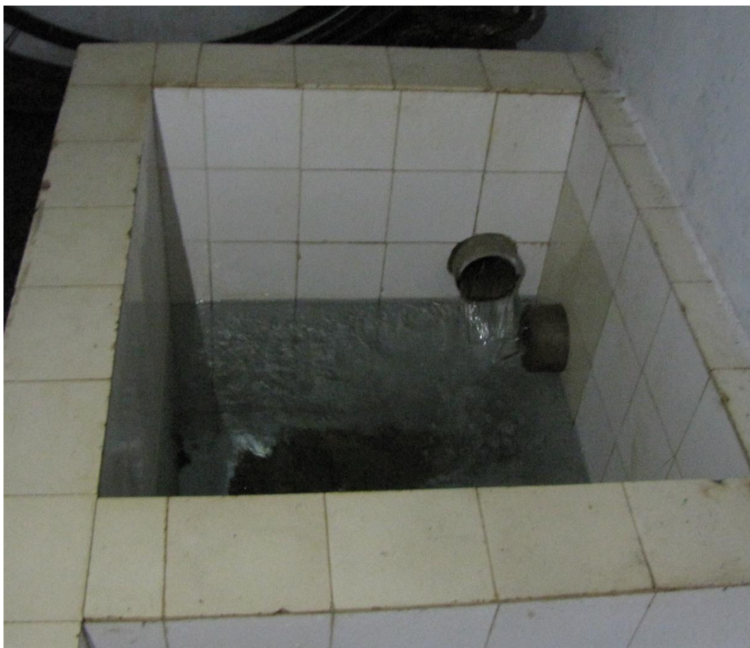
Pormenor do ponto de água.
