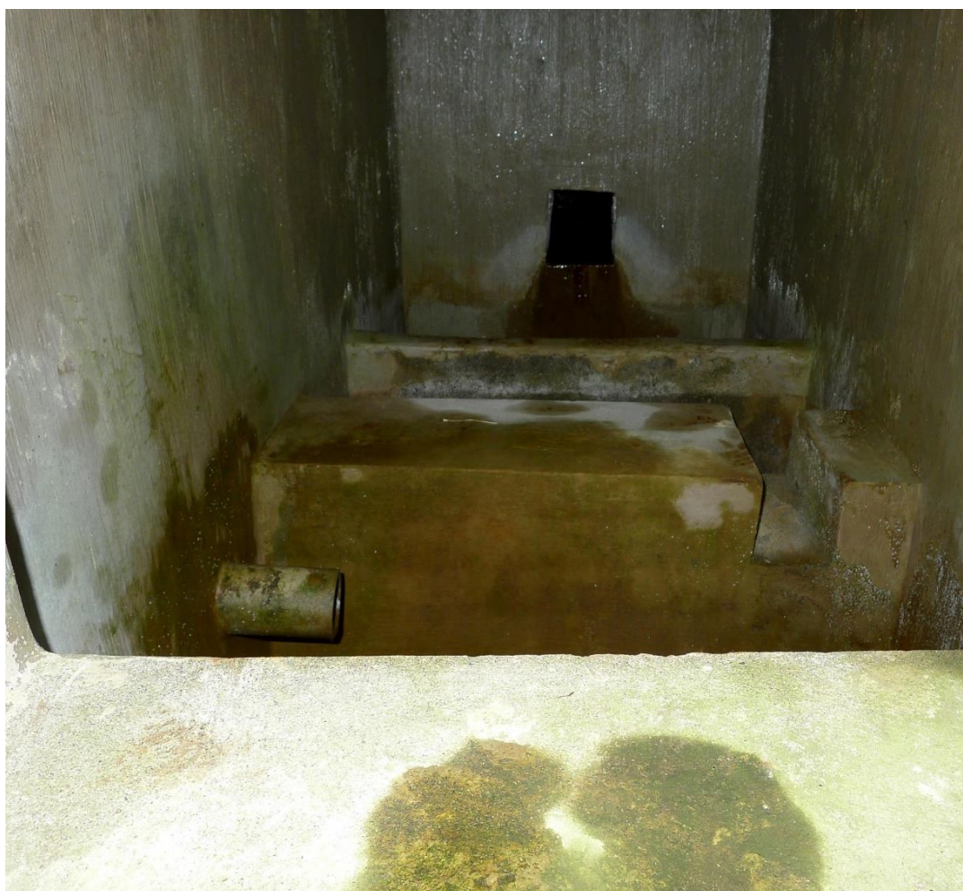
Pormenor do ponto de água.
