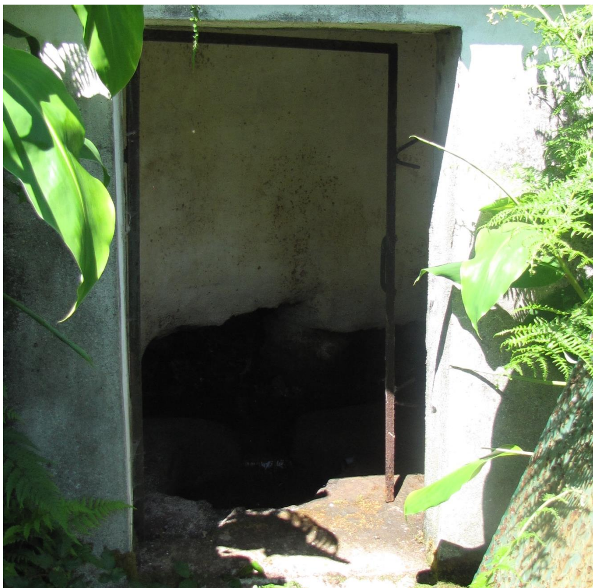
Vista geral do ponto de água.
