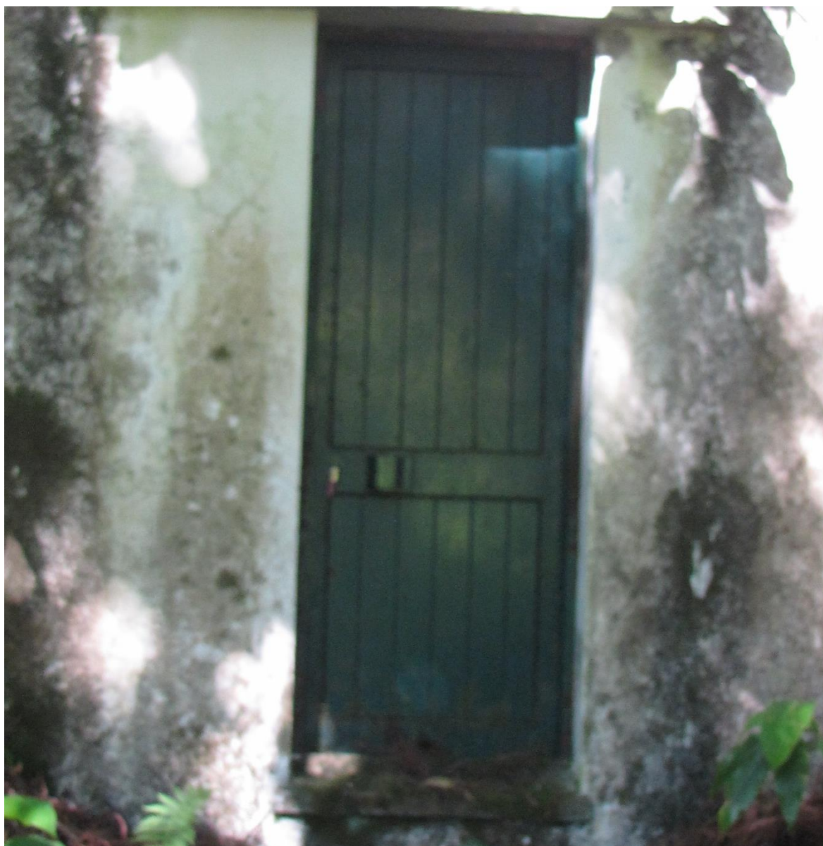
Vista geral do ponto de água.
