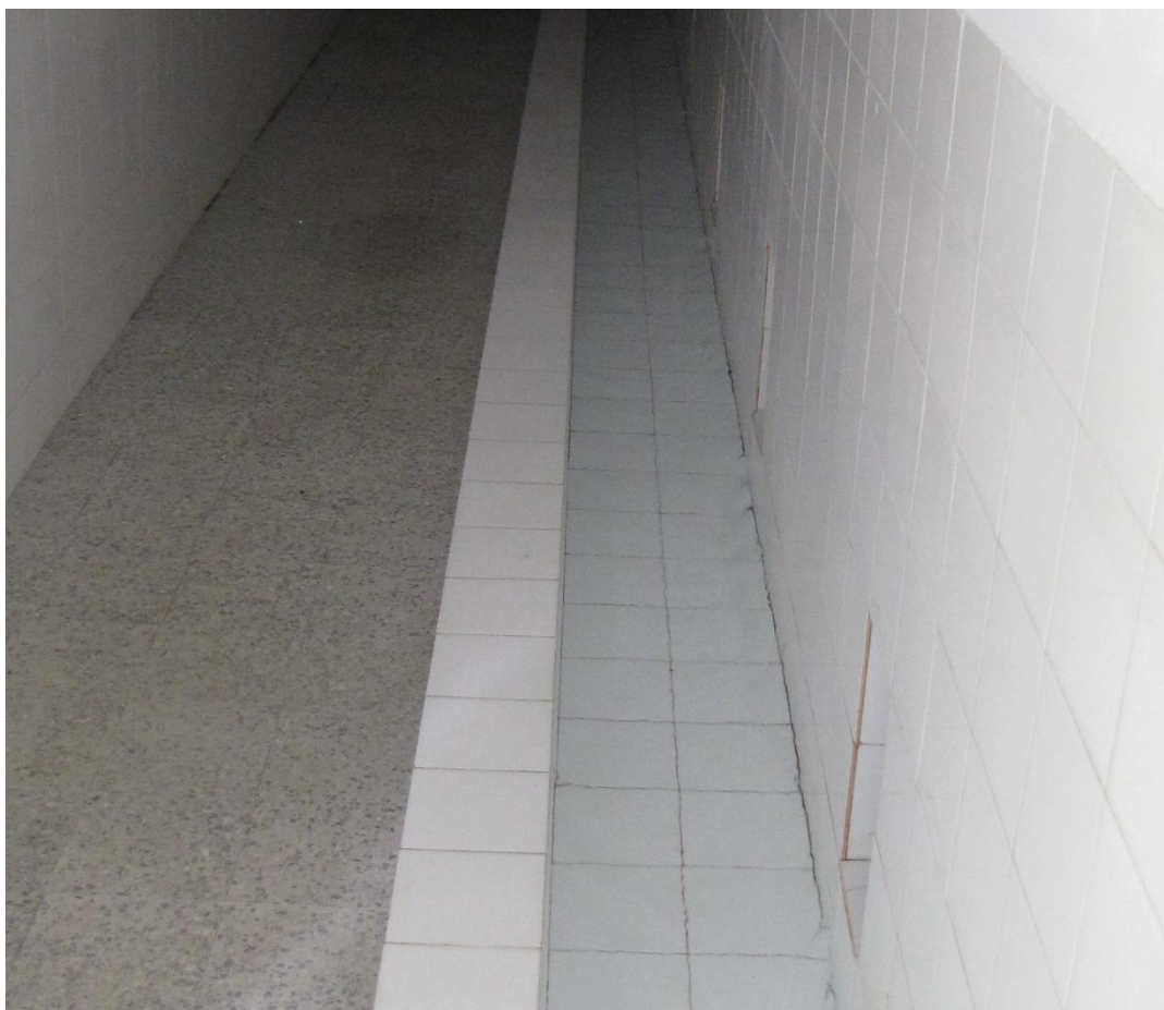
Pormenor do ponto de água.
