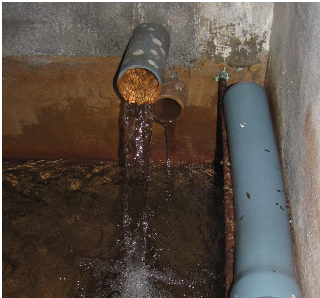
Pormenor do ponto de água.
