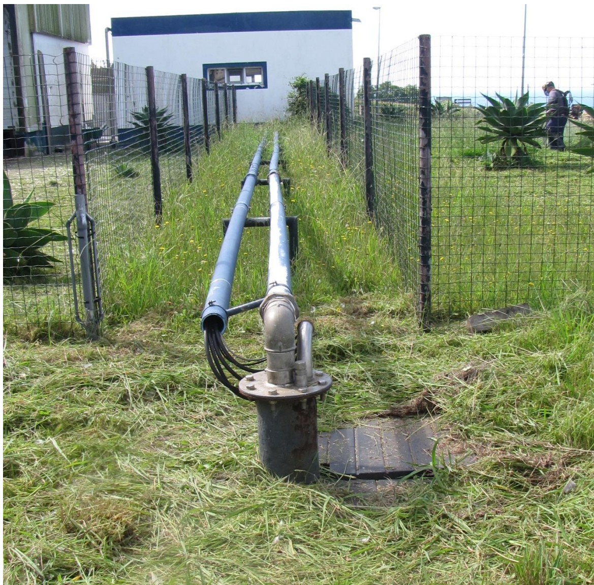
Vista geral do ponto de água.
