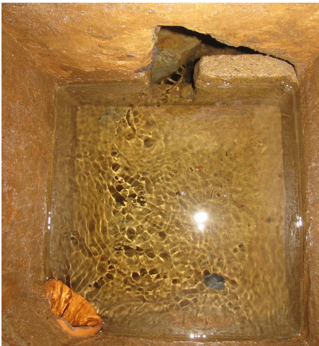
Pormenor do ponto de água.
