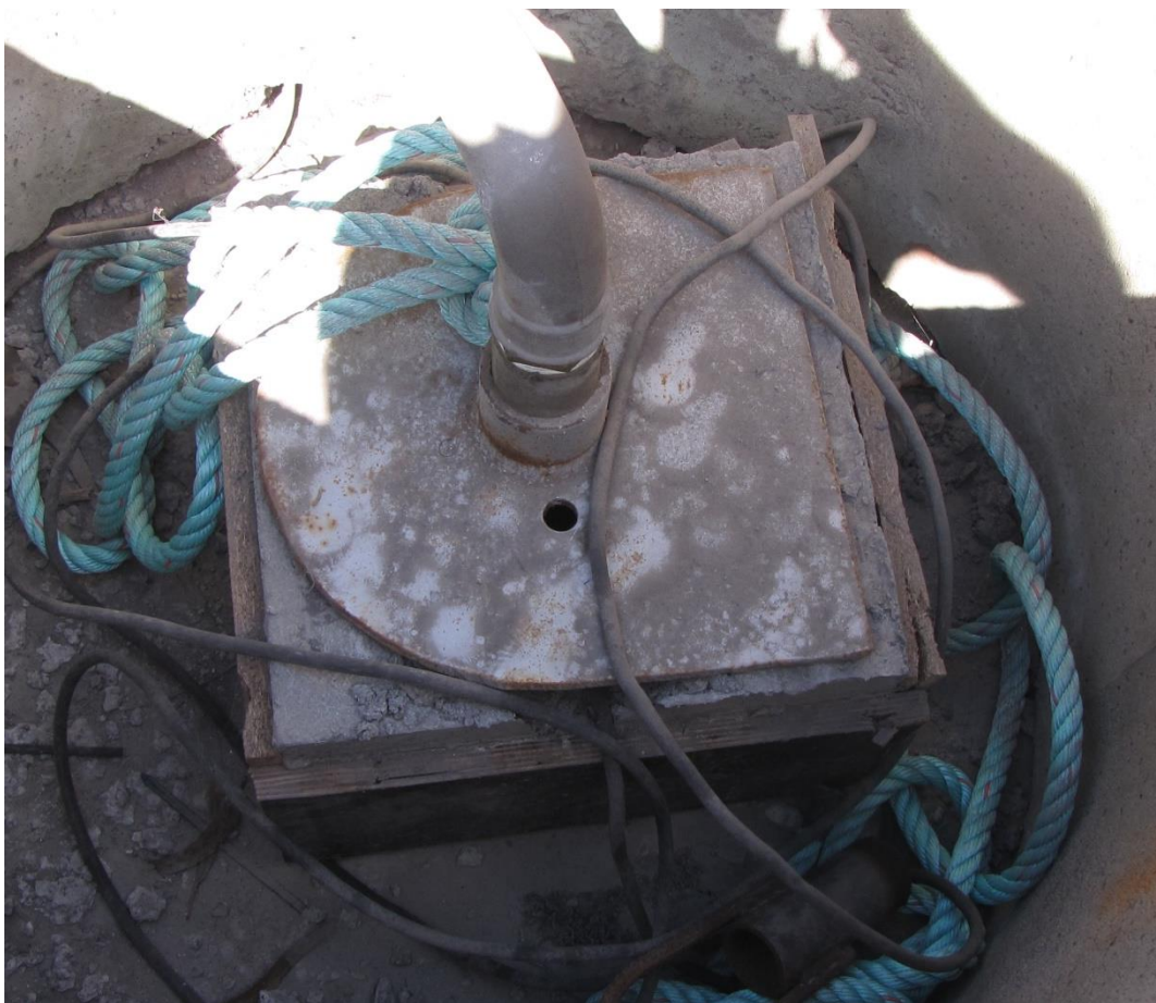
Pormenor do ponto de água.
