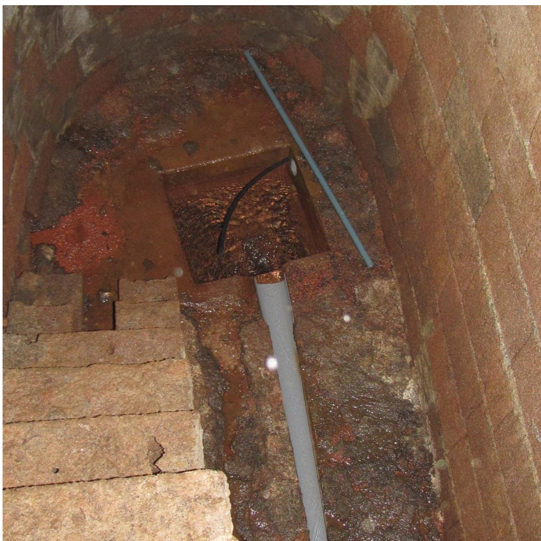
Pormenor do ponto de água.
