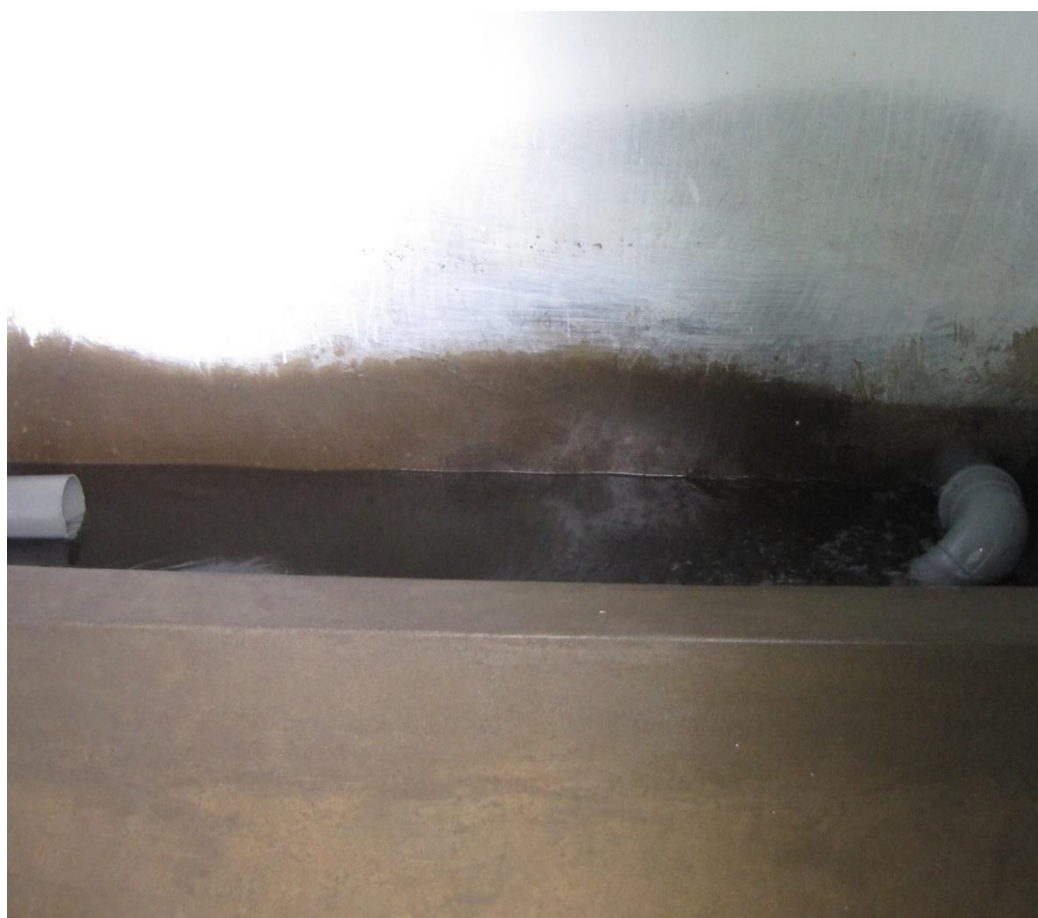
Pormenor do ponto de água.
