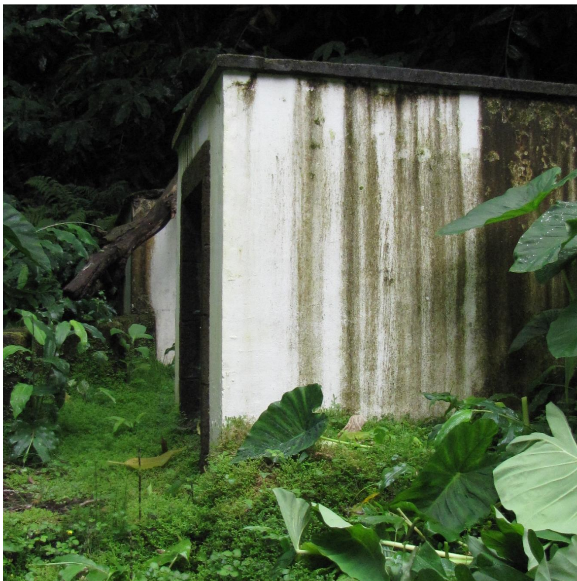
Vista geral do ponto de água.
