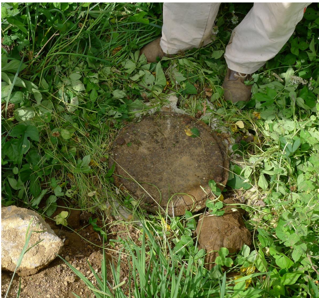
Pormenor do ponto de água.
