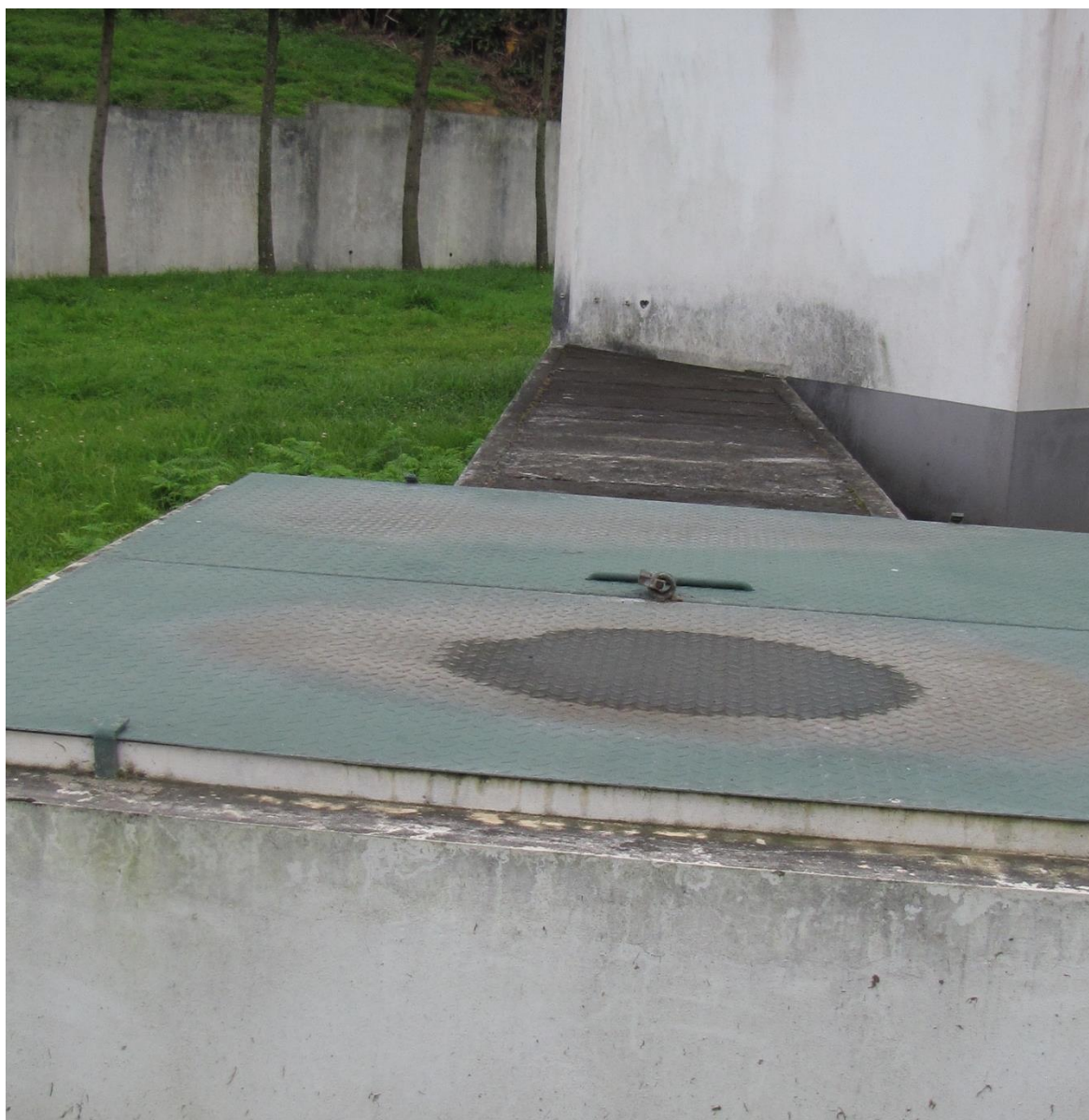
Vista geral do ponto de água.
