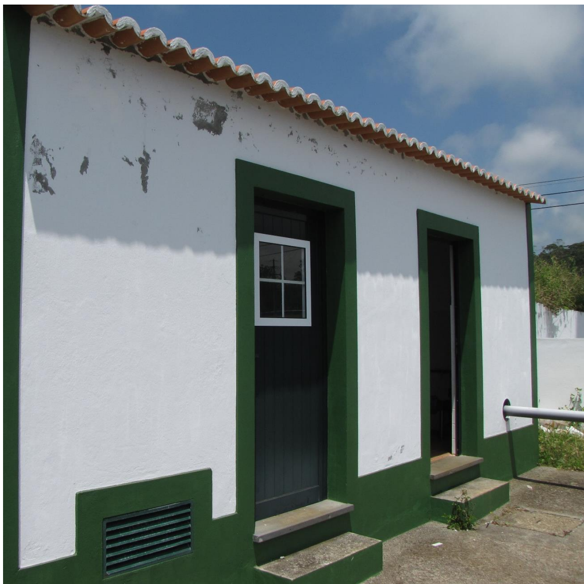
Vista geral do ponto de água.
