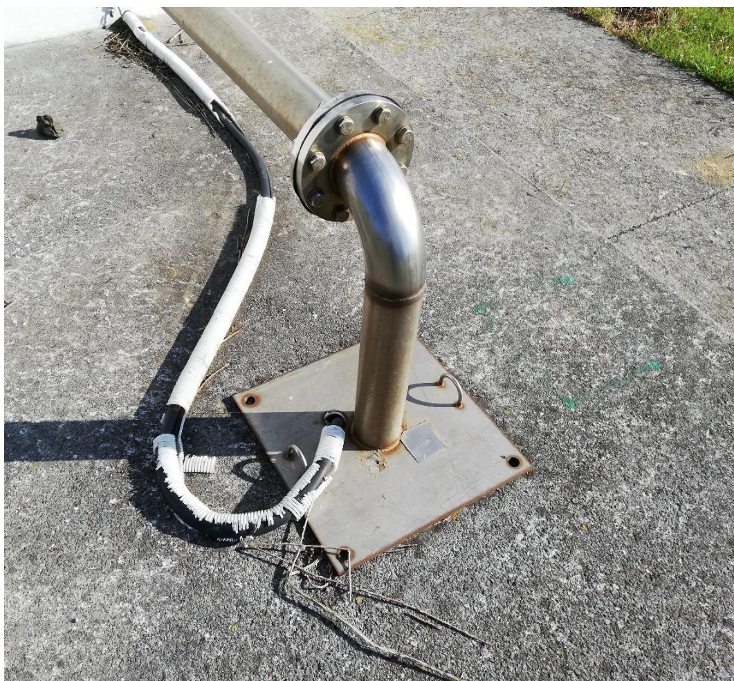
Pormenor do ponto de água.
