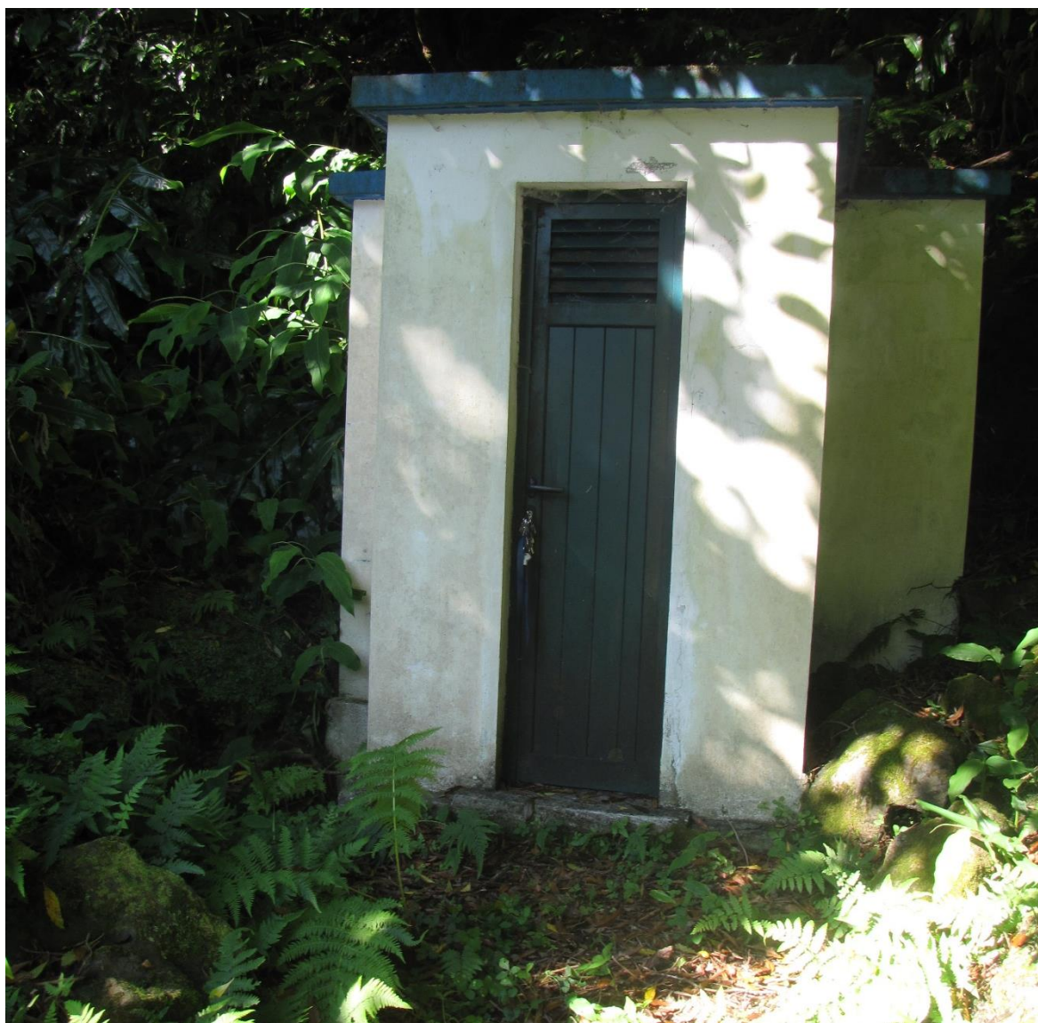
Vista geral do ponto de água.
