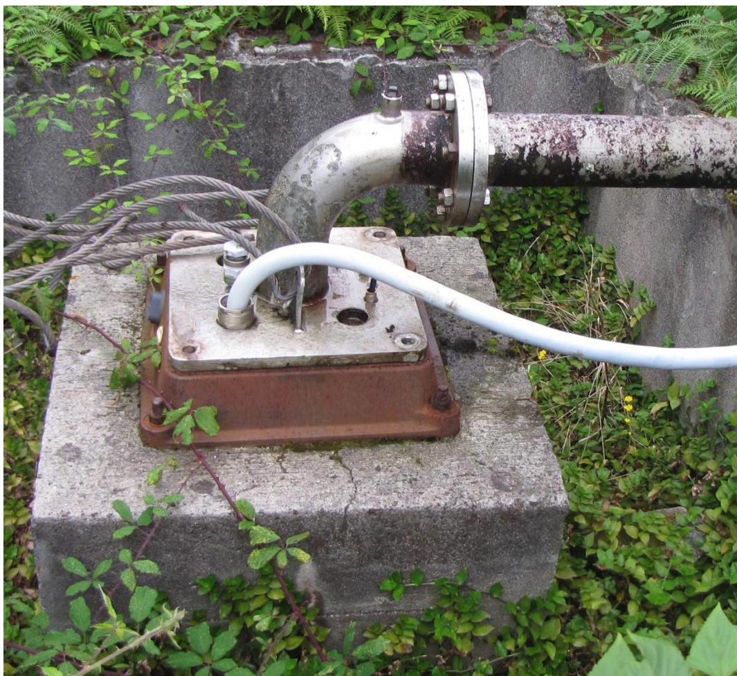
Pormenor do ponto de água.
