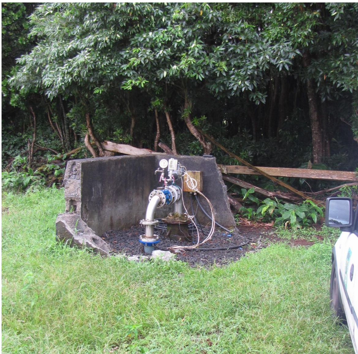
Vista geral do ponto de água.
