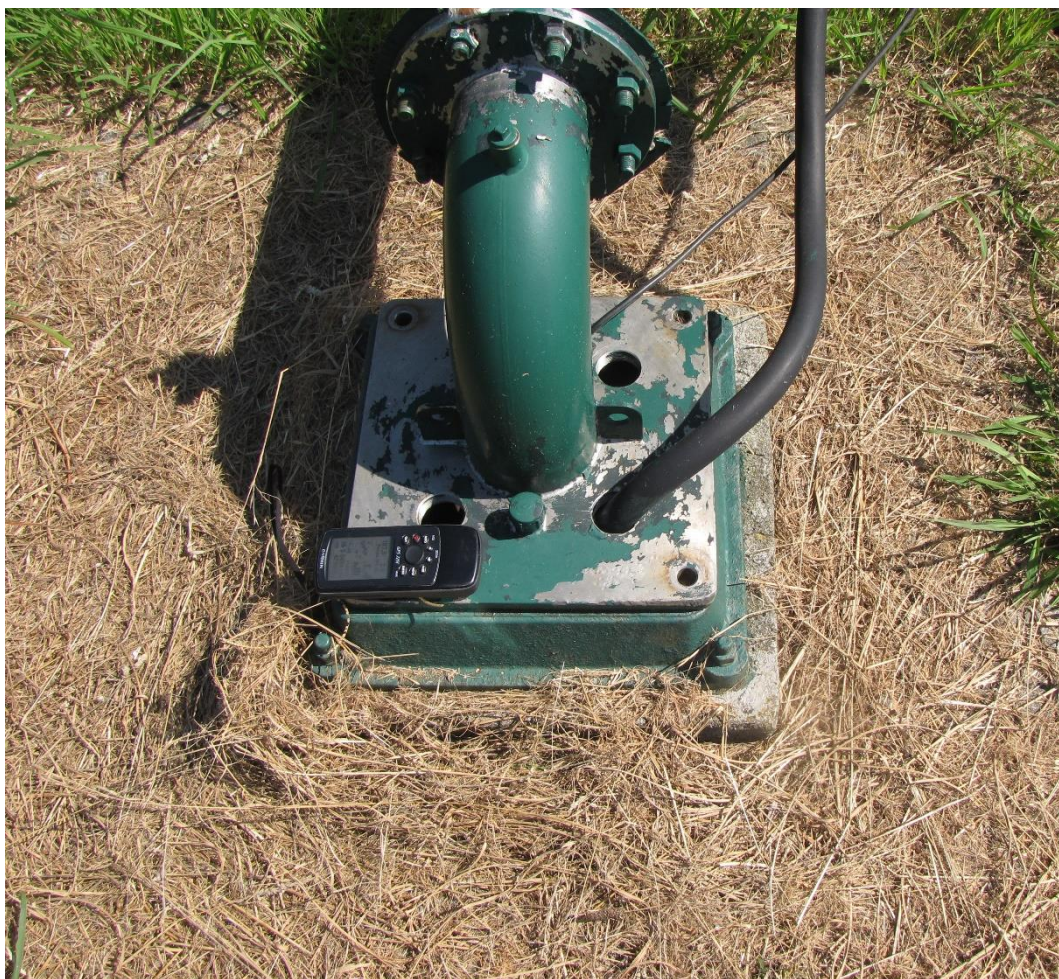
Pormenor do ponto de água.
