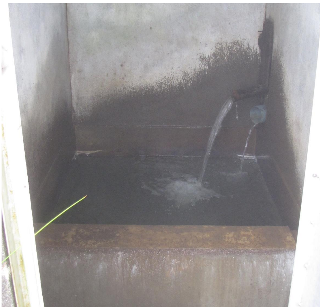
Pormenor do ponto de água.
