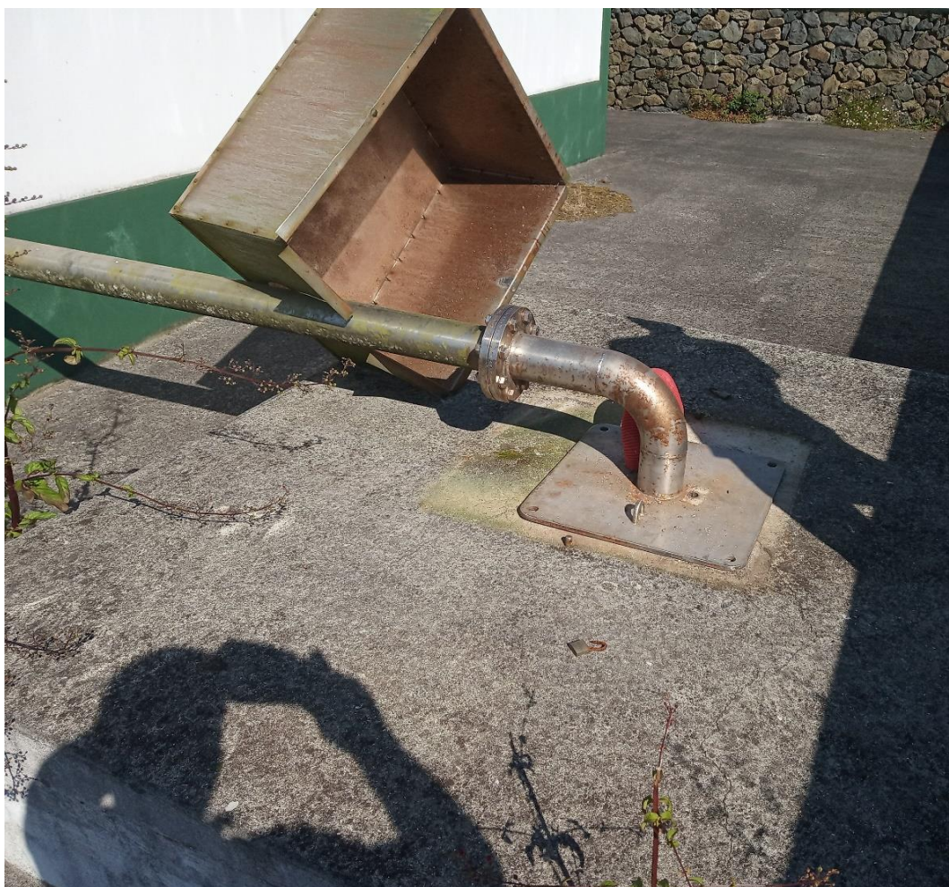
Pormenor do ponto de água.
