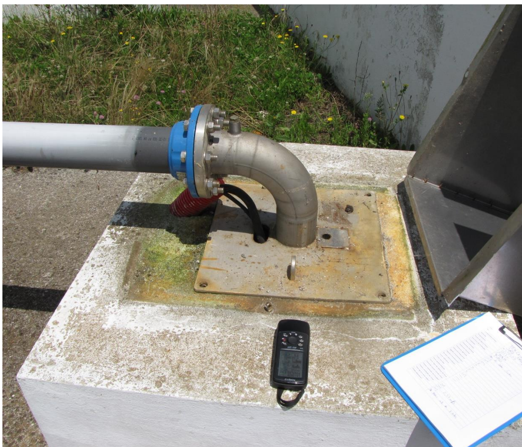
Pormenor do ponto de água.
