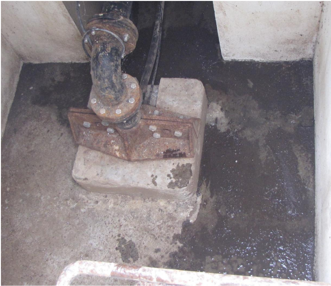
Pormenor do ponto de água.
