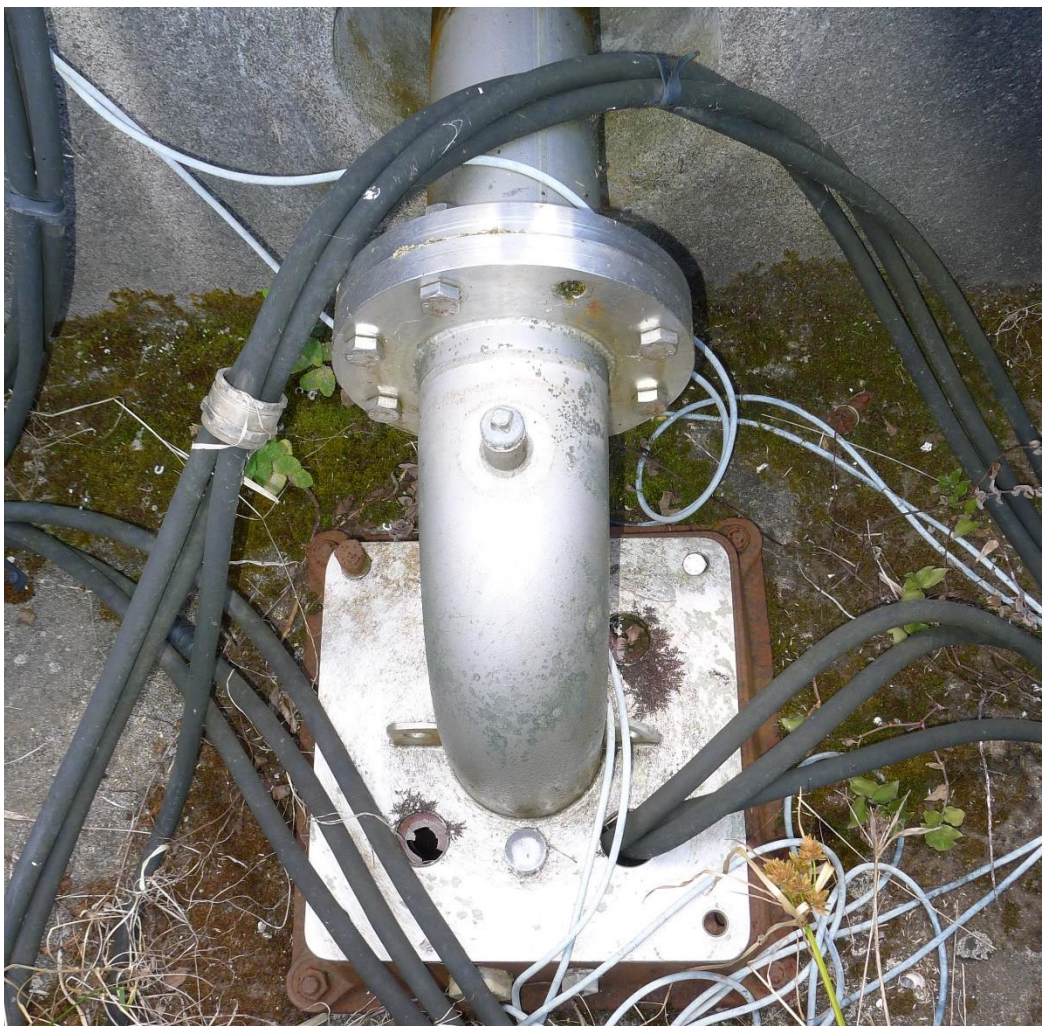
Pormenor do ponto de água.
