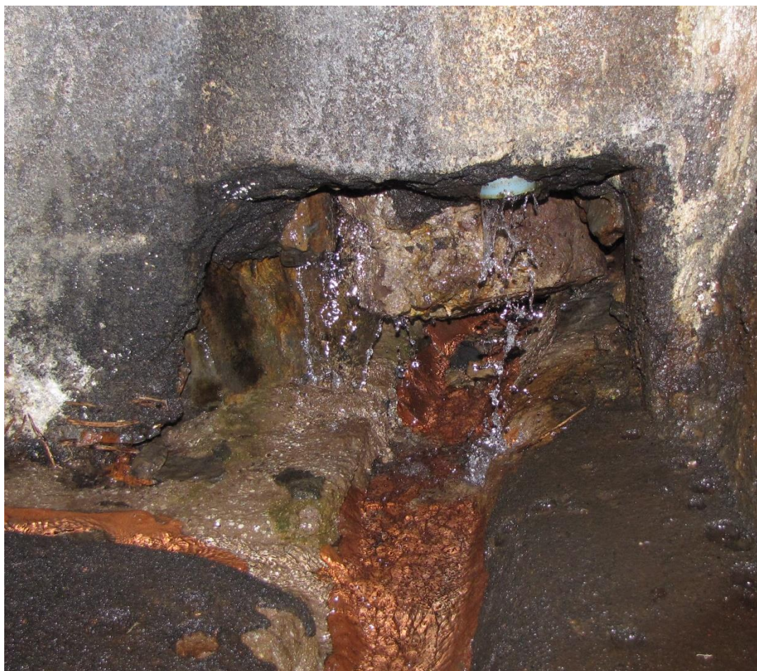
Pormenor do ponto de água.
