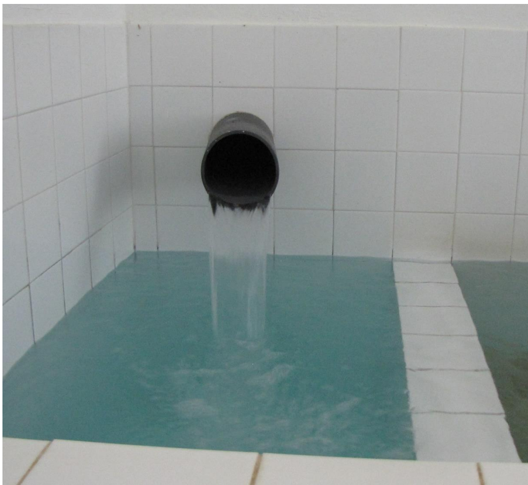
Pormenor do ponto de água.
