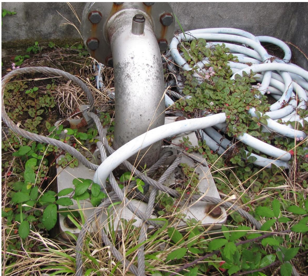
Pormenor do ponto de água.
