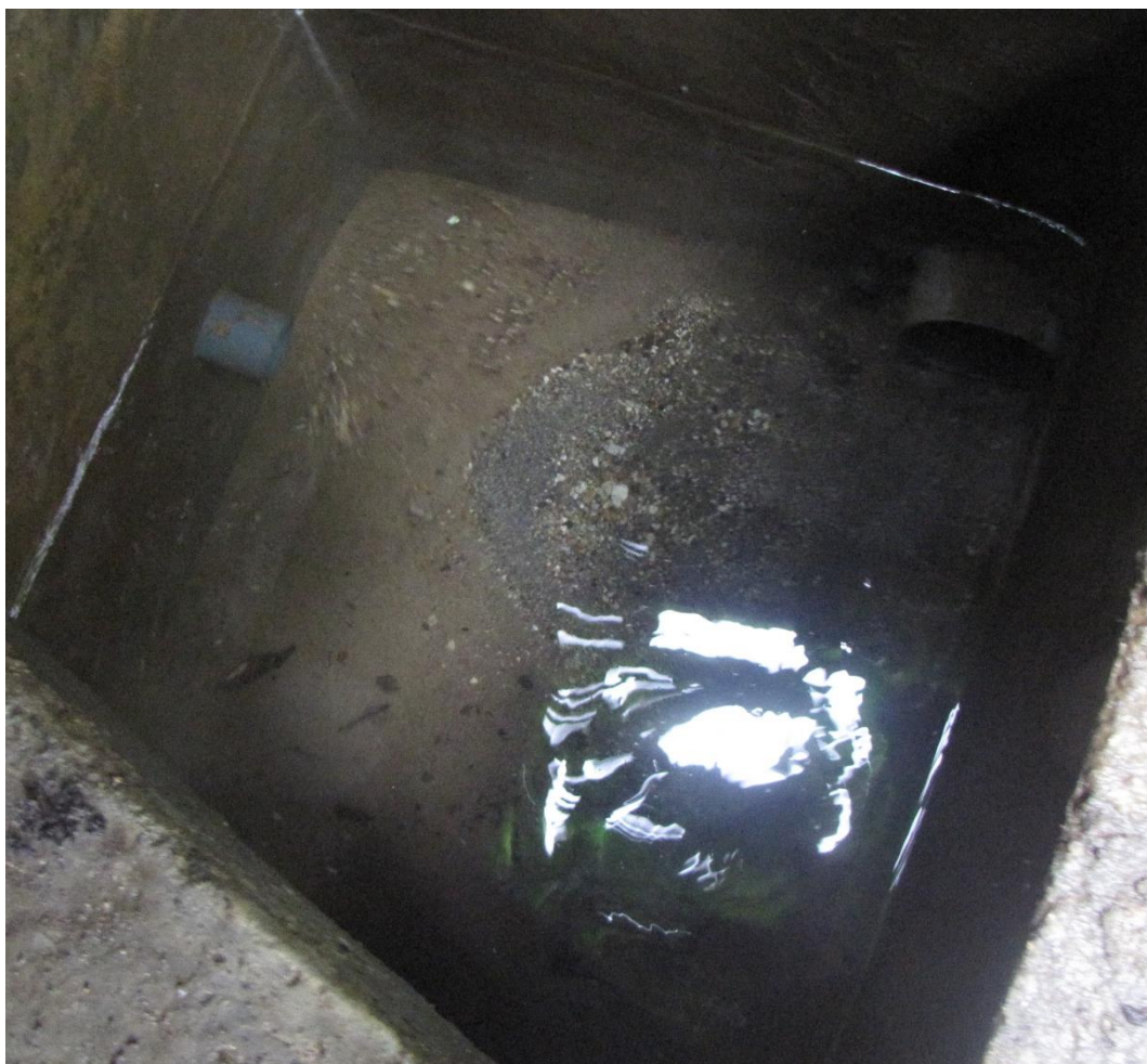
Pormenor do ponto de água.
