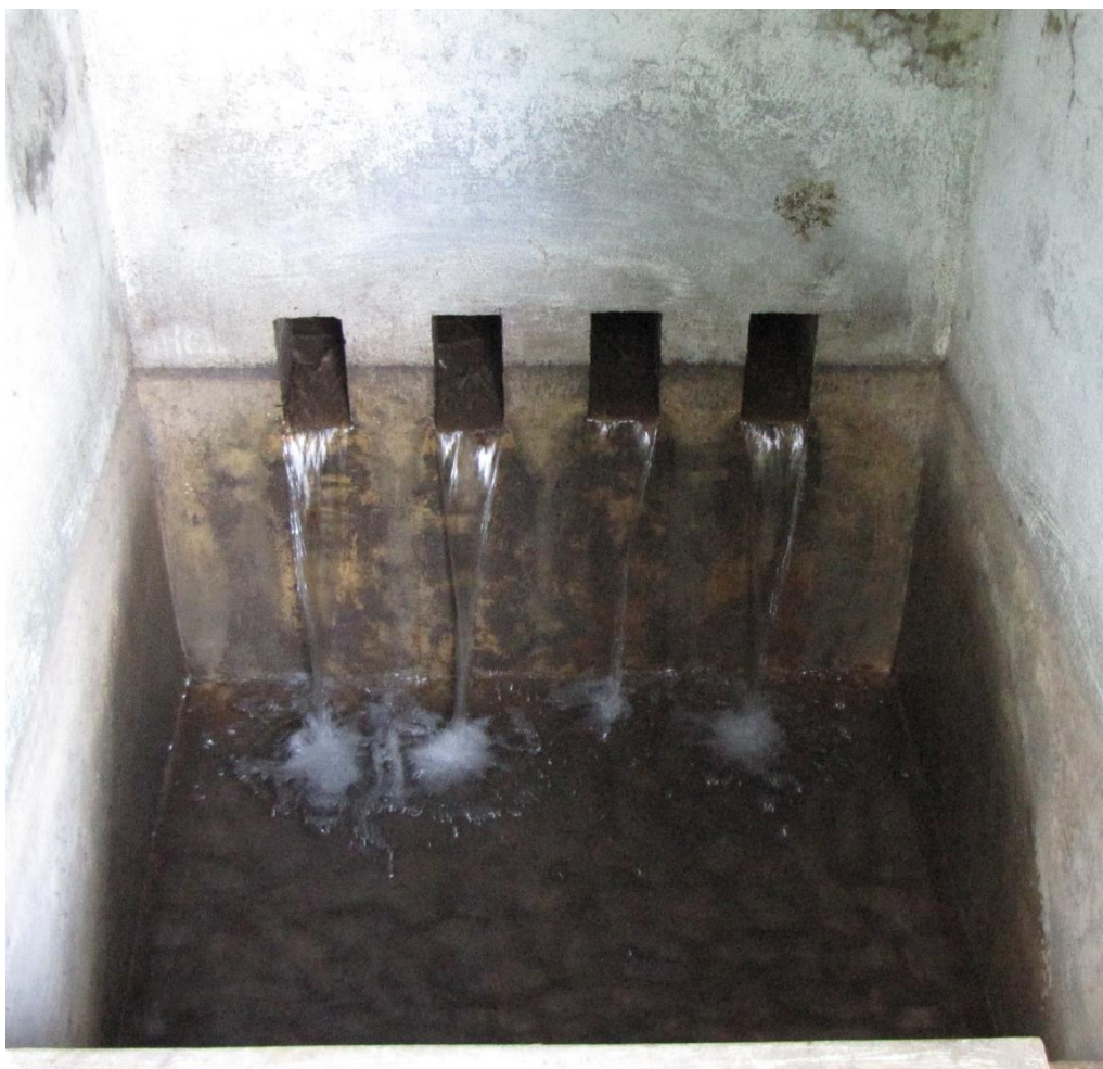
Pormenor do ponto de água.
