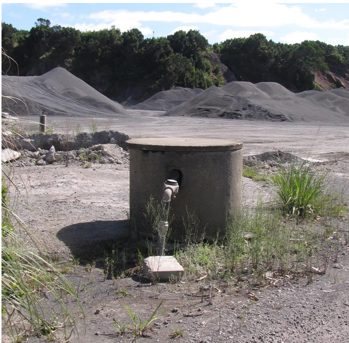
Vista geral do ponto de água.
