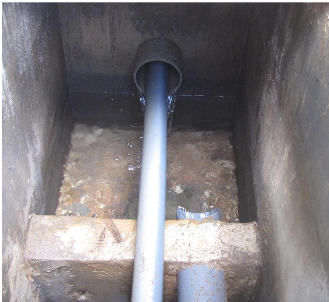
Pormenor do ponto de água.
