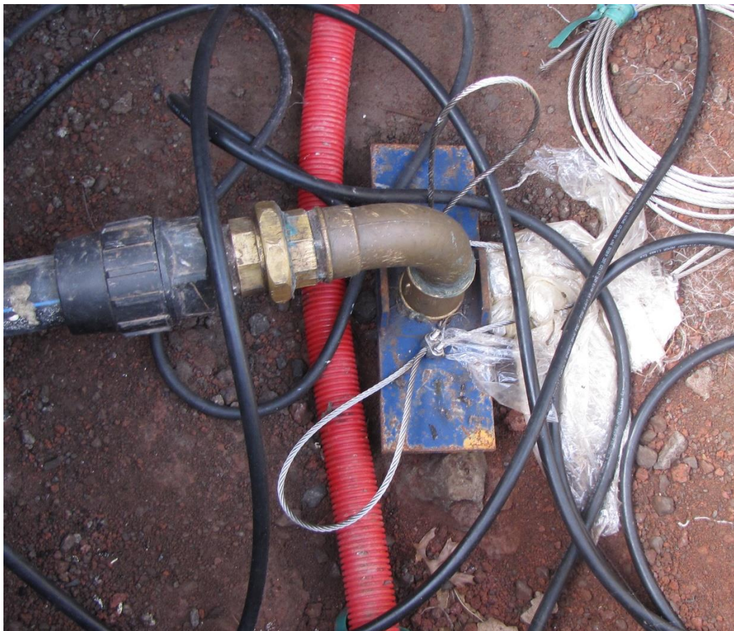
Pormenor do ponto de água.
