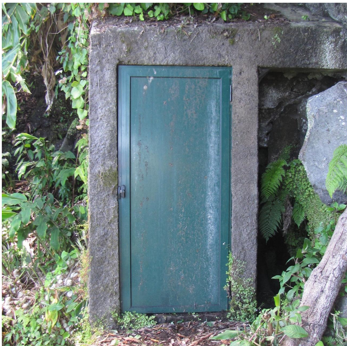
Vista geral do ponto de água.
