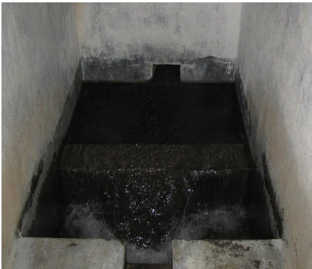
Pormenor do ponto de água.
