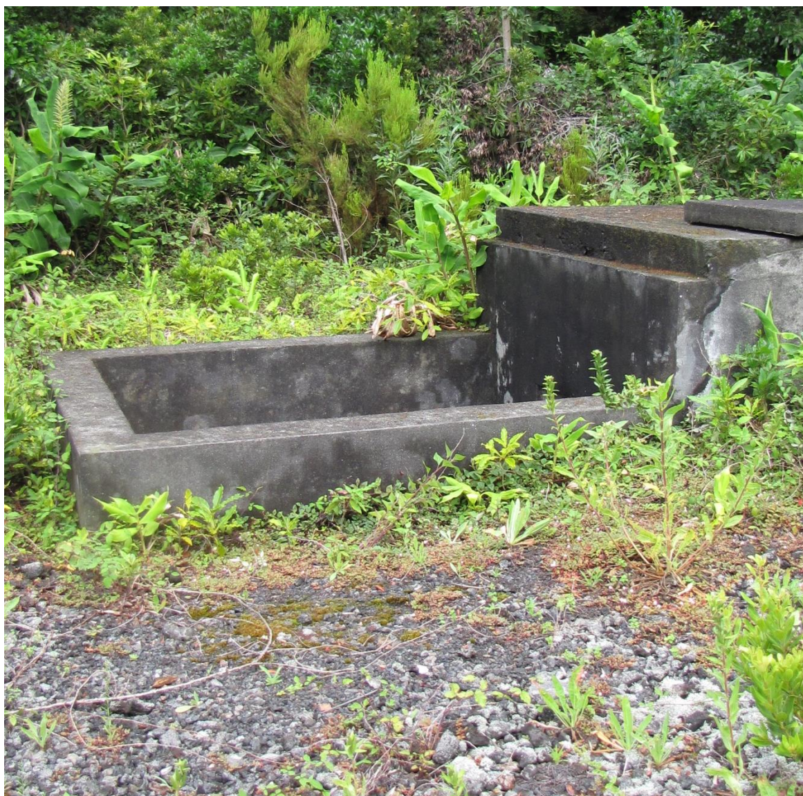
Vista geral do ponto de água.
