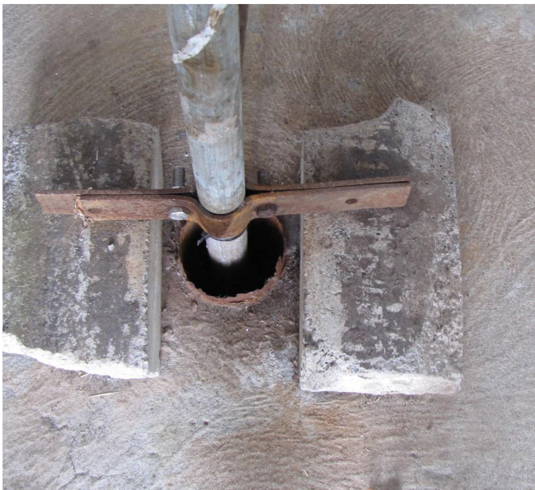
Pormenor do ponto de água.
