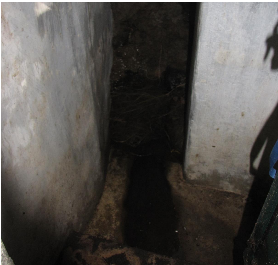
Pormenor do ponto de água.
