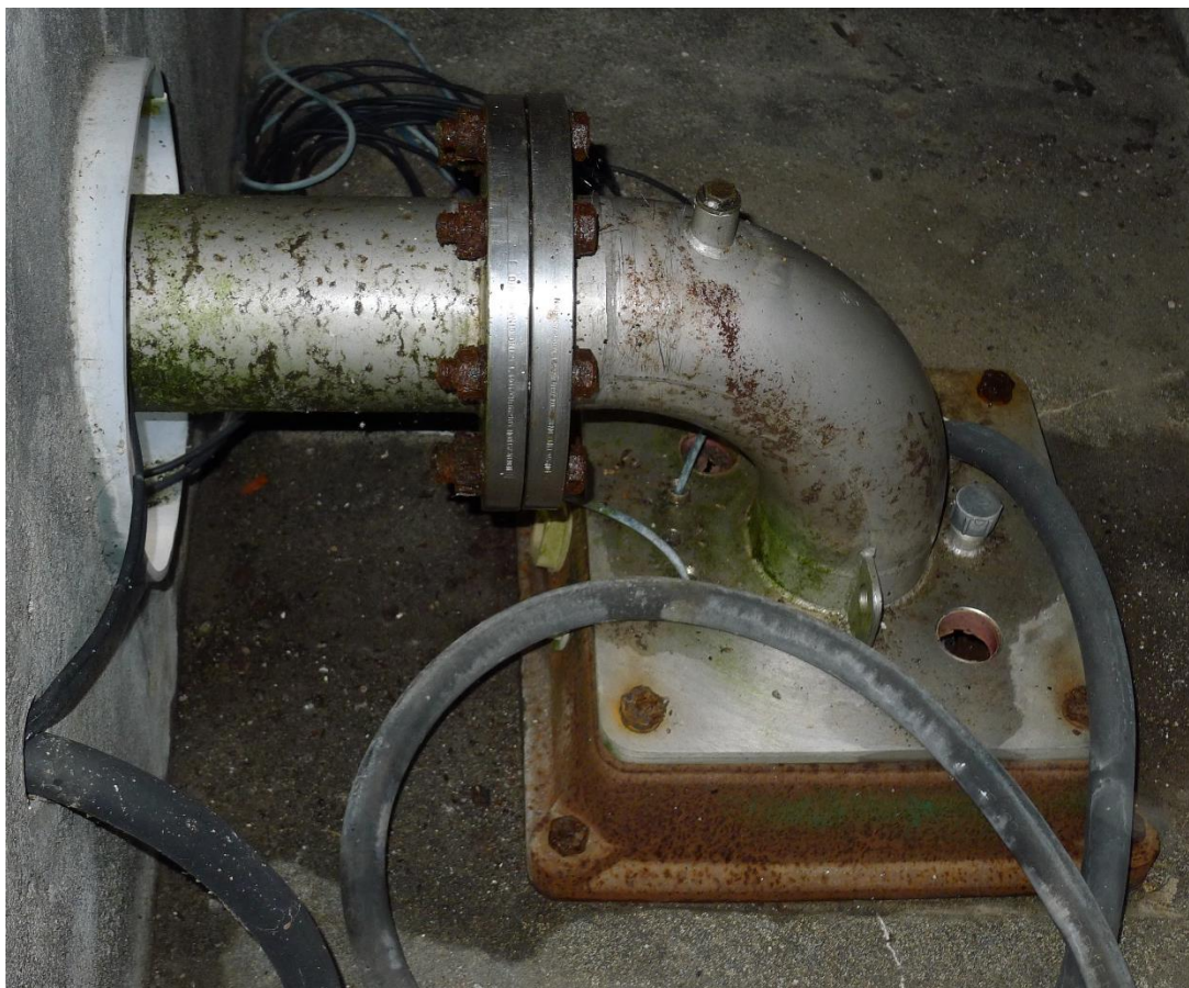
Pormenor do ponto de água.
