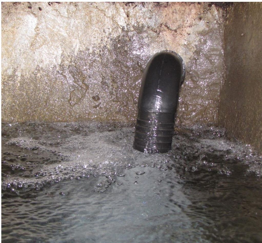
Pormenor do ponto de água.
