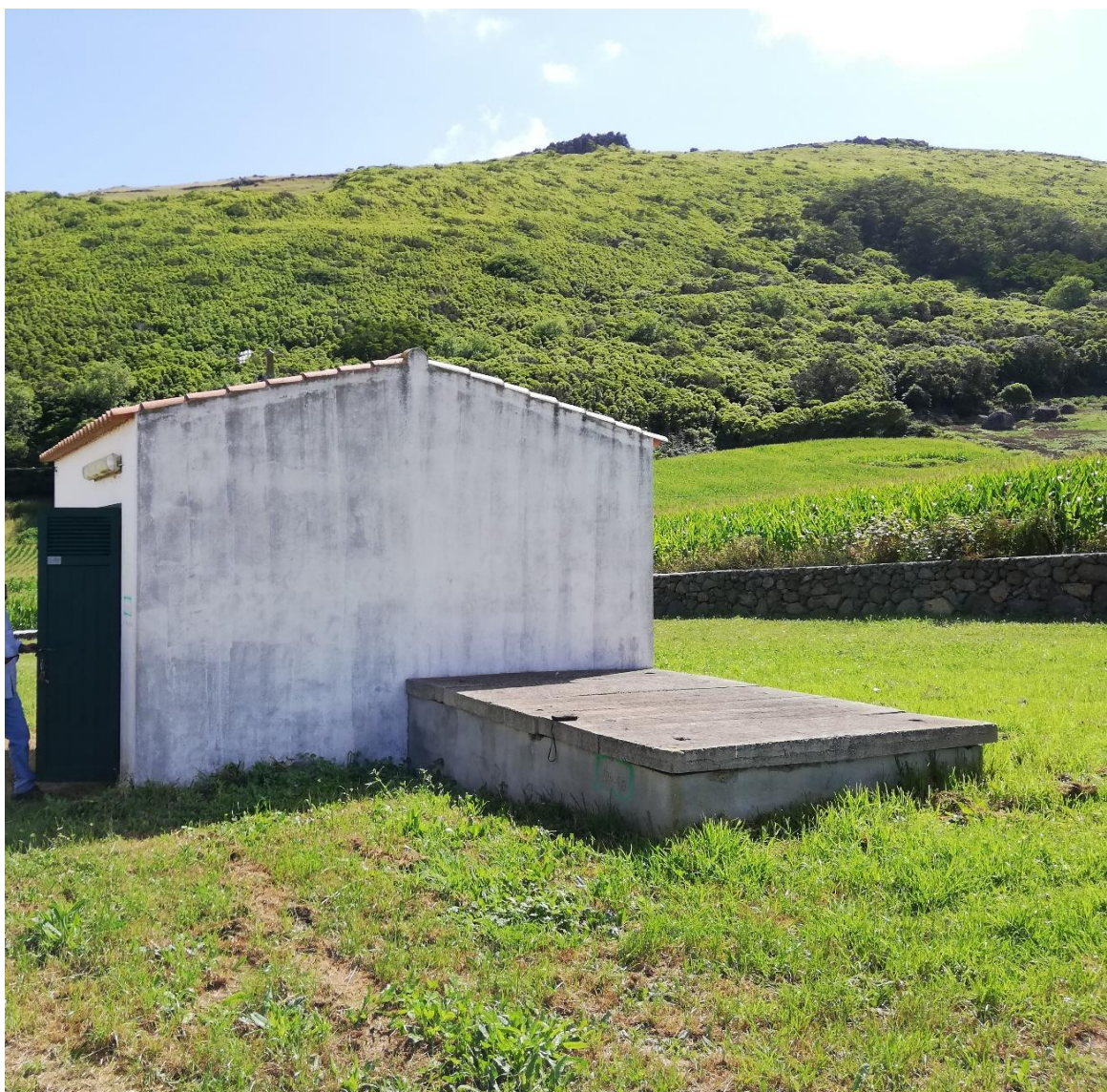
Vista geral do ponto de água.
