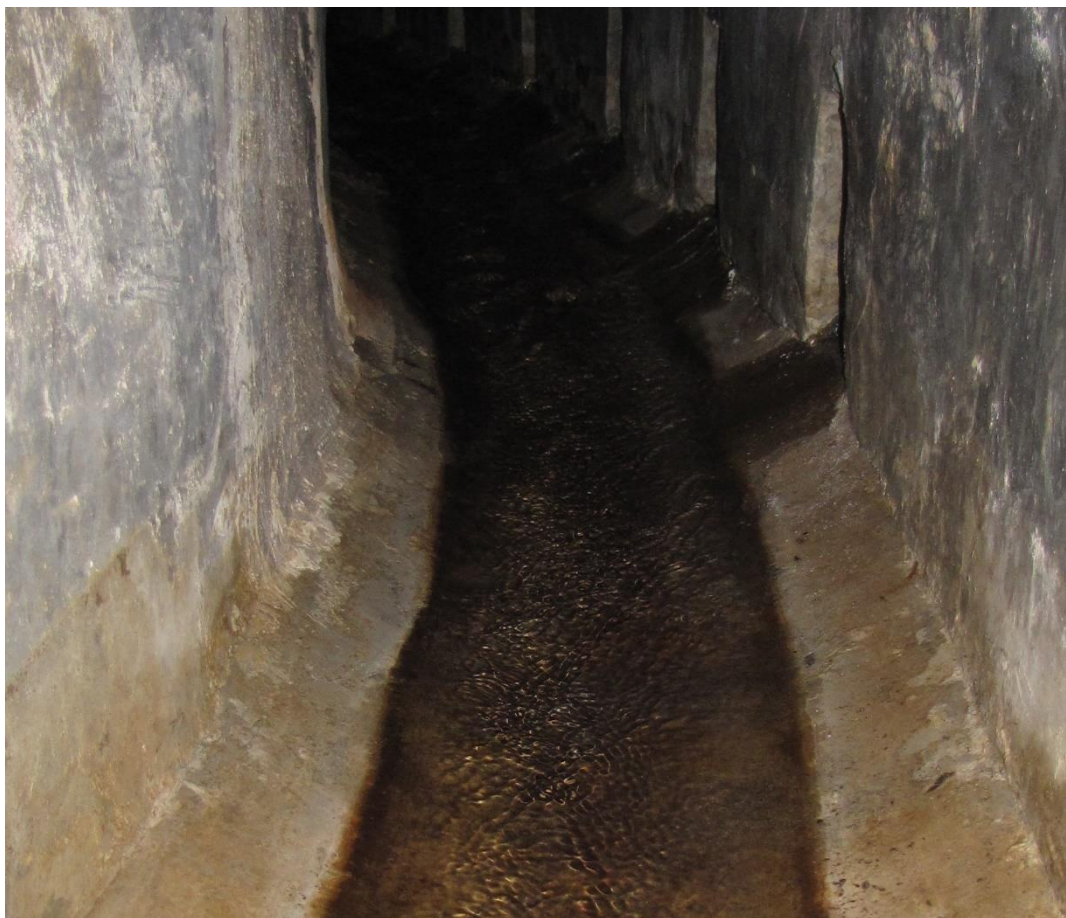
Pormenor do ponto de água.
