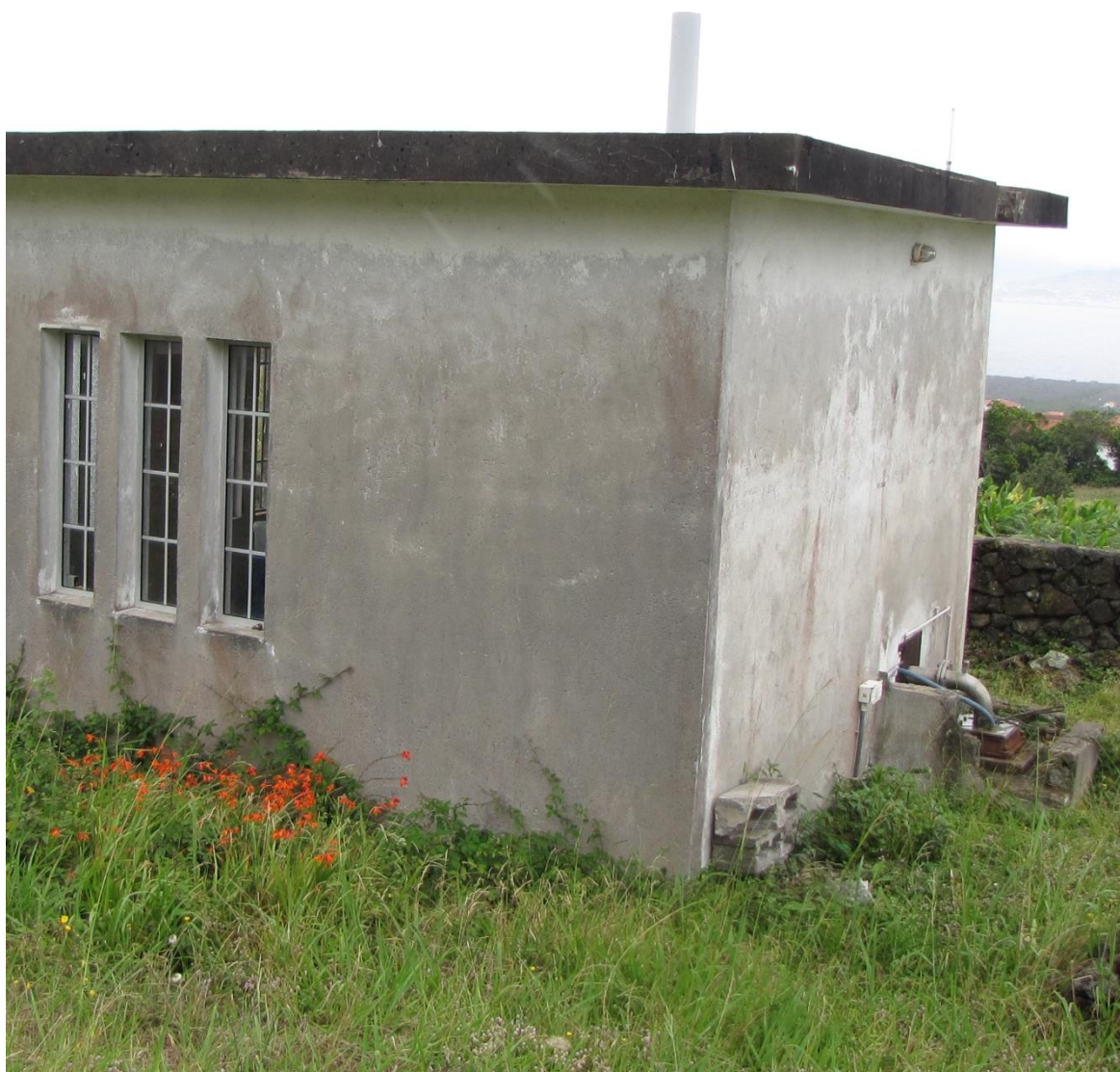
Vista geral do ponto de água.
