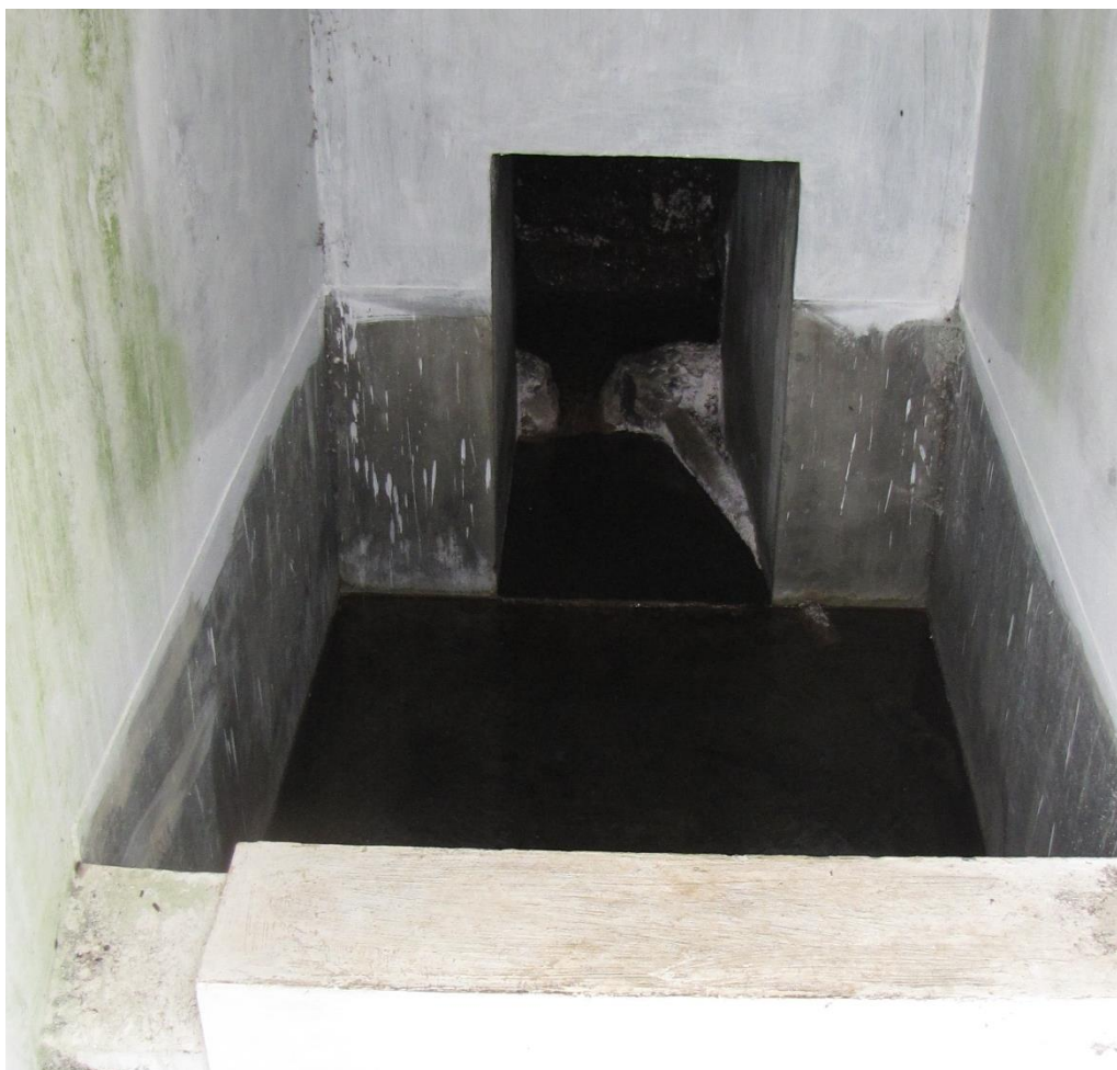
Pormenor do ponto de água.
