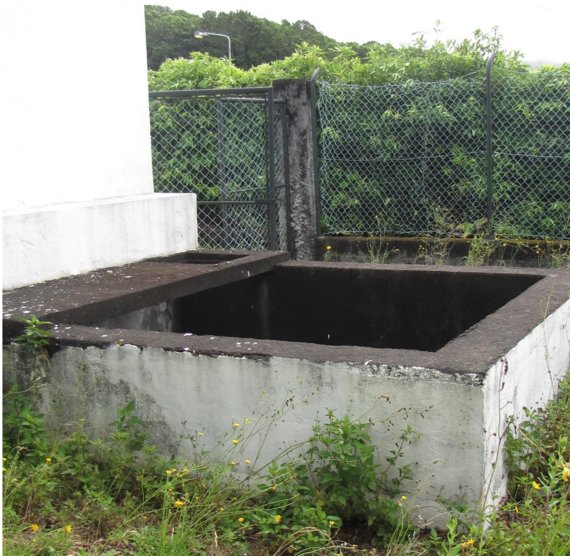
Vista geral do ponto de água.
