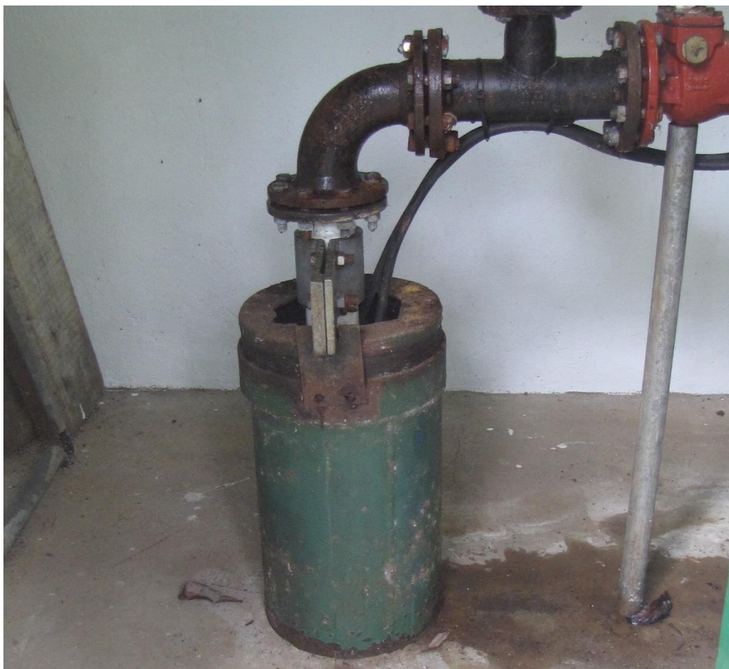
Pormenor do ponto de água.
