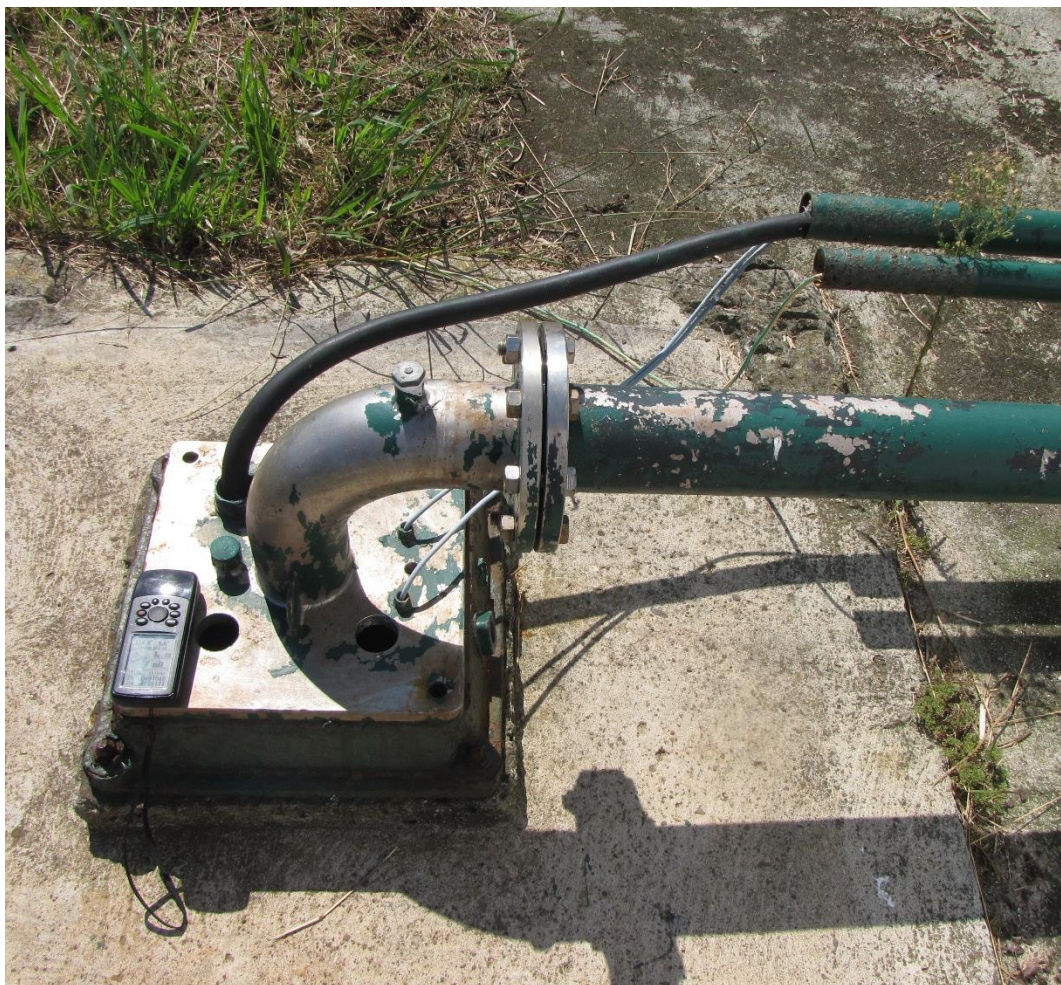
Pormenor do ponto de água.
