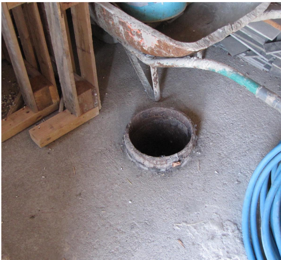
Pormenor do ponto de água.
