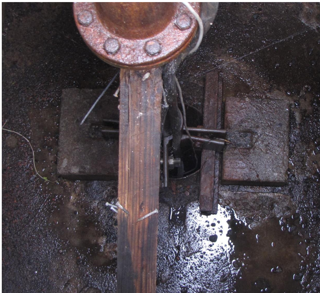
Pormenor do ponto de água.
