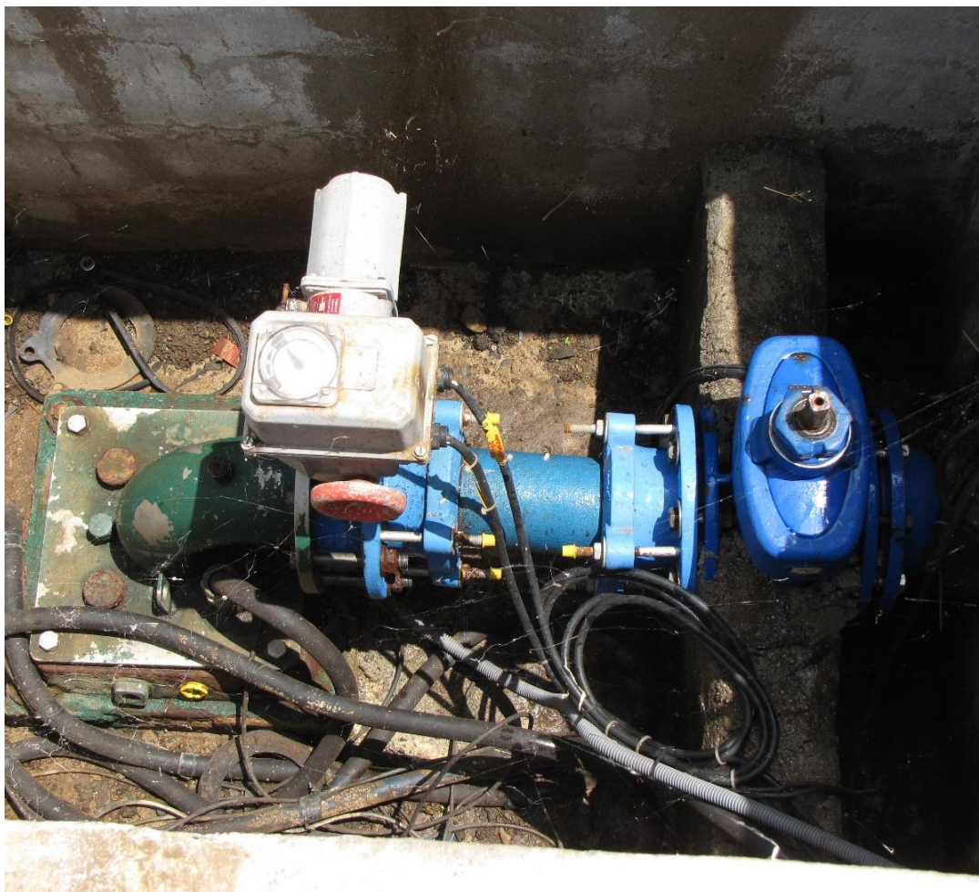
Pormenor do ponto de água.
