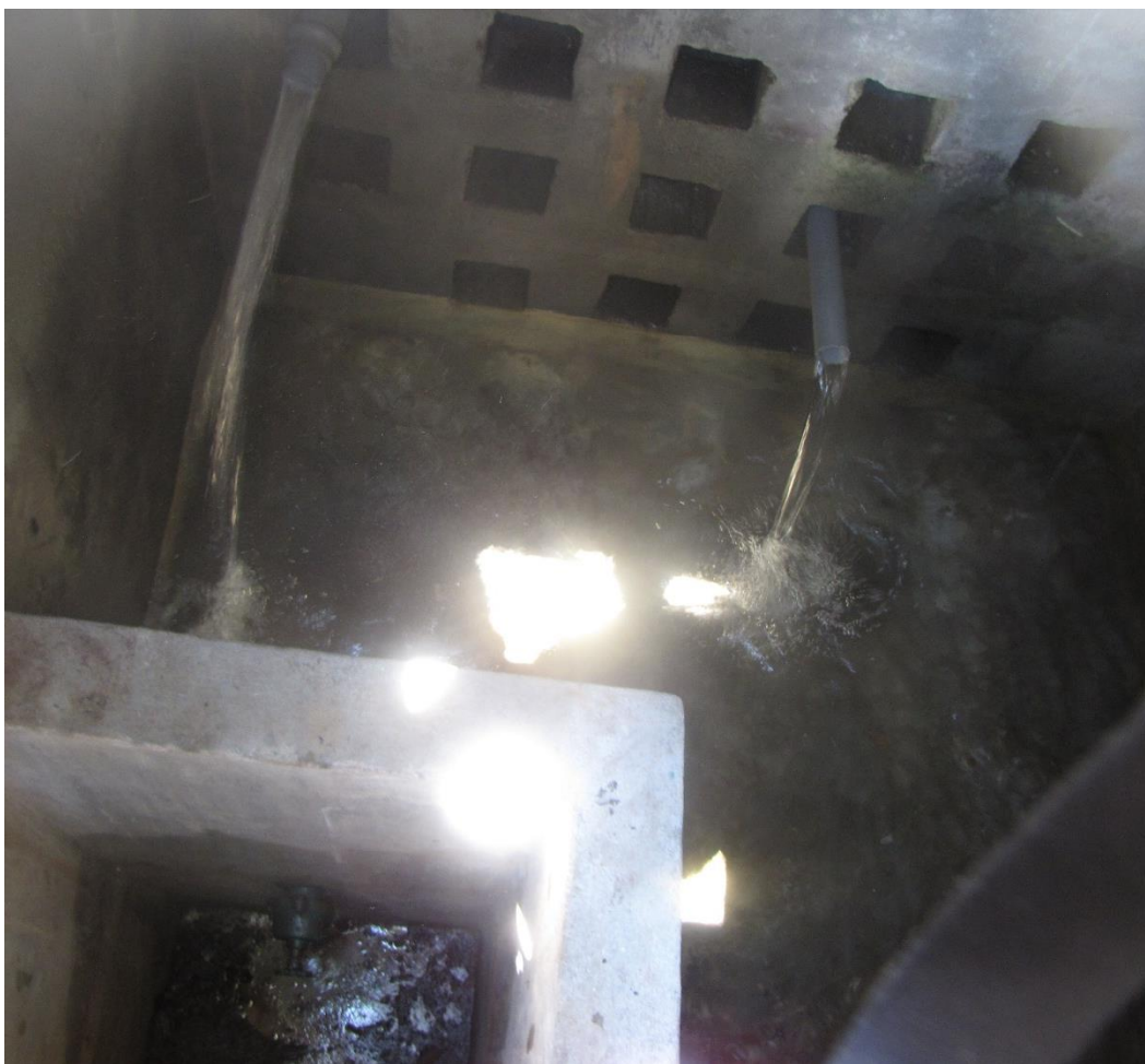
Pormenor do ponto de água.
