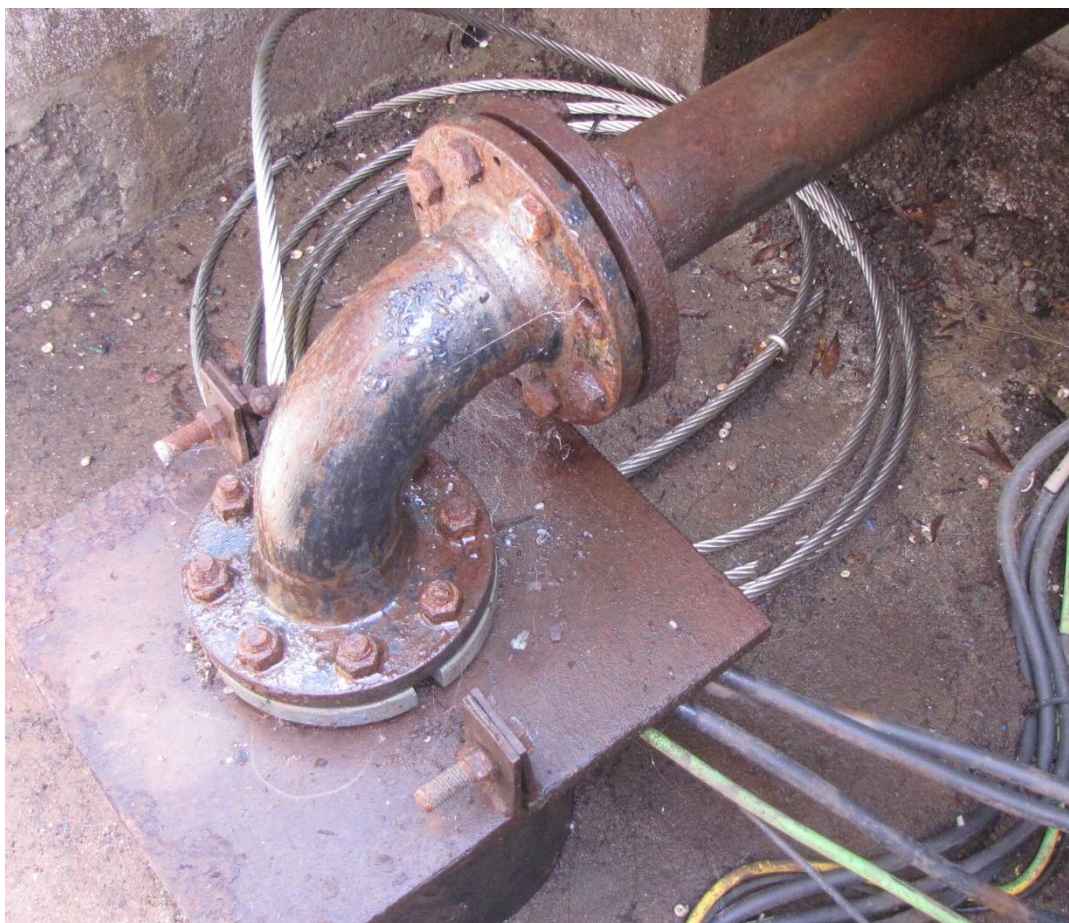
Pormenor do ponto de água.
