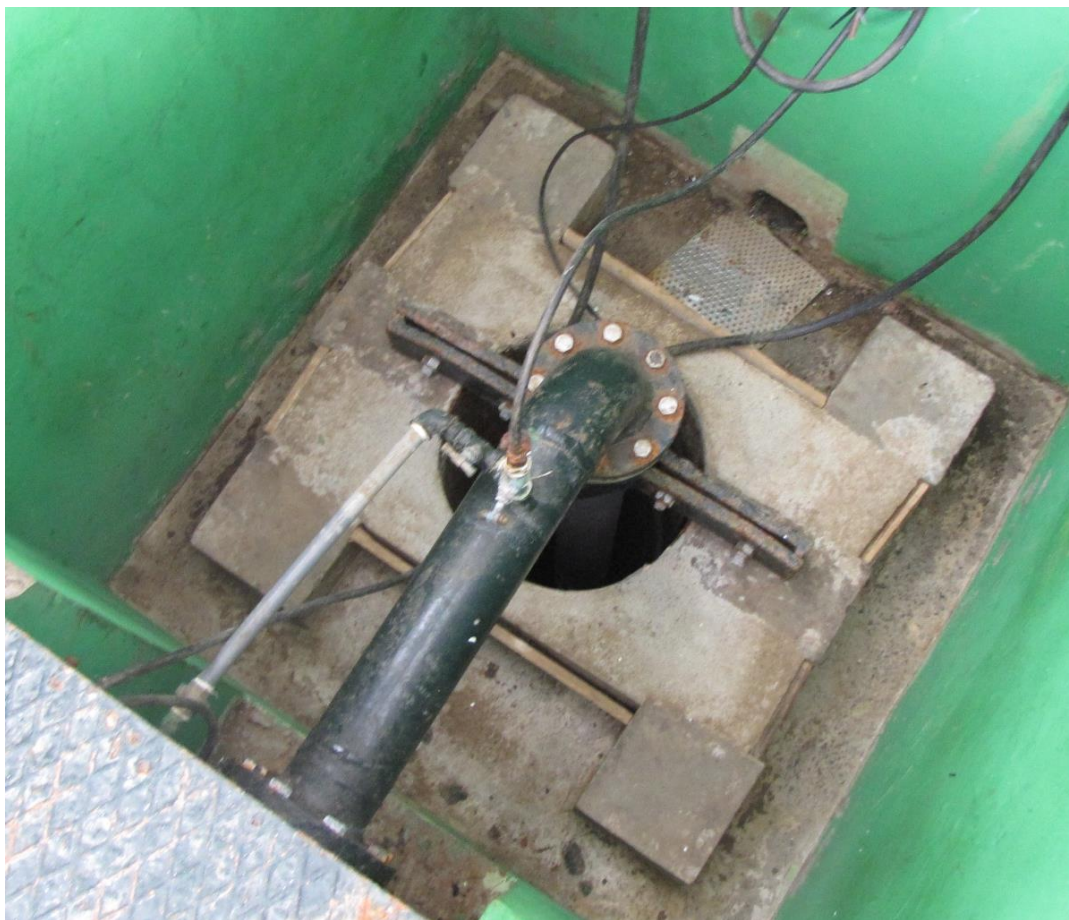
Pormenor do ponto de água.
