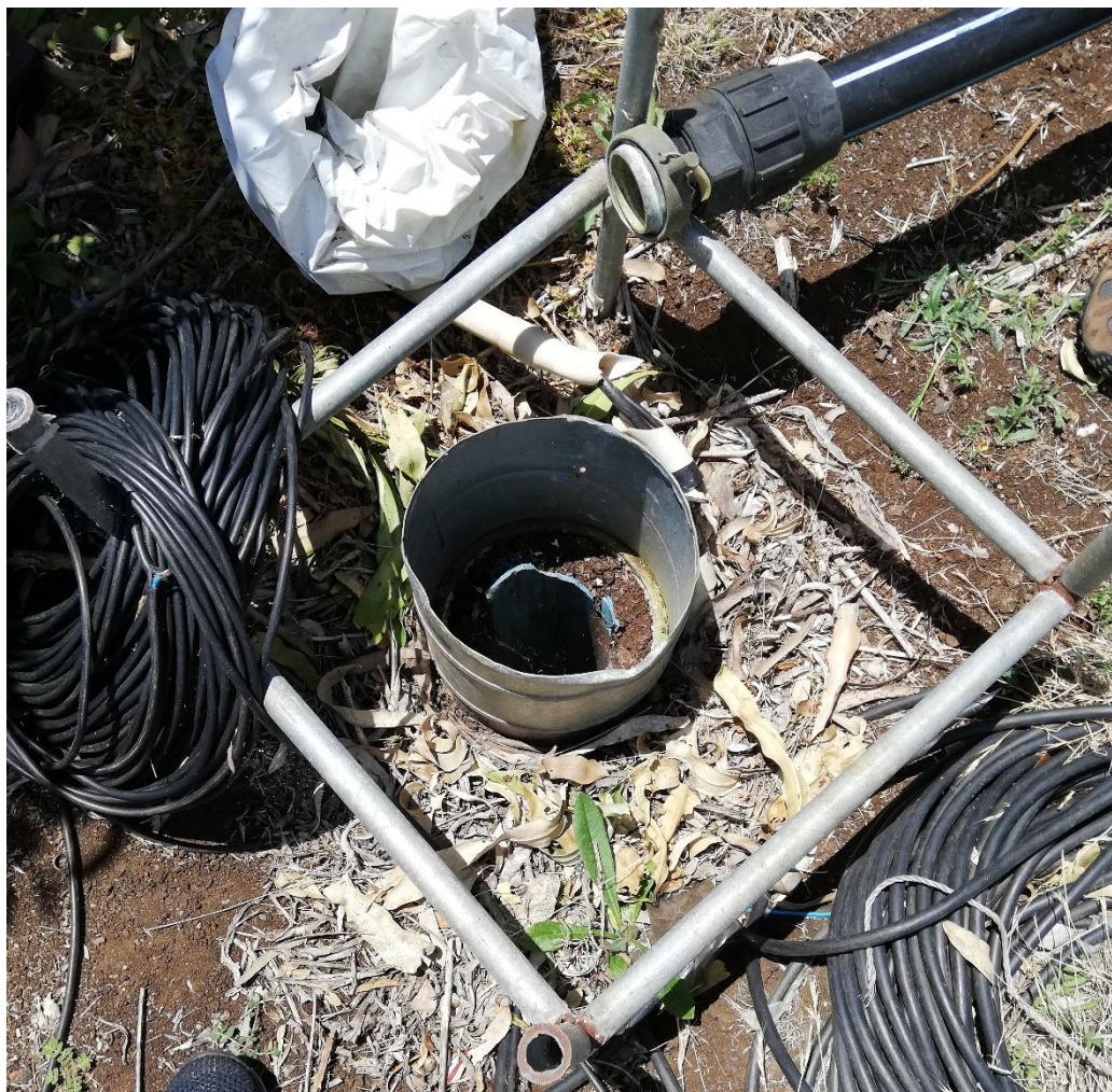
Pormenor do ponto de água.
