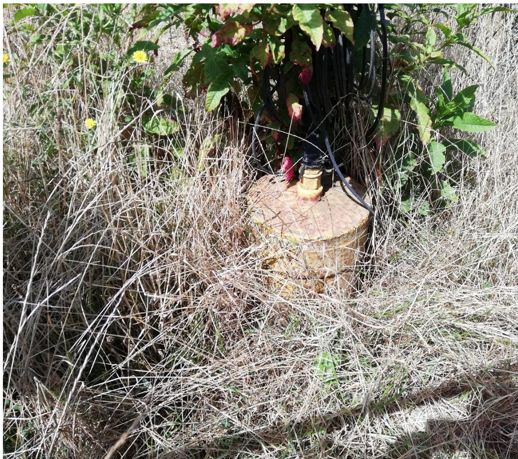
Pormenor do ponto de água.
