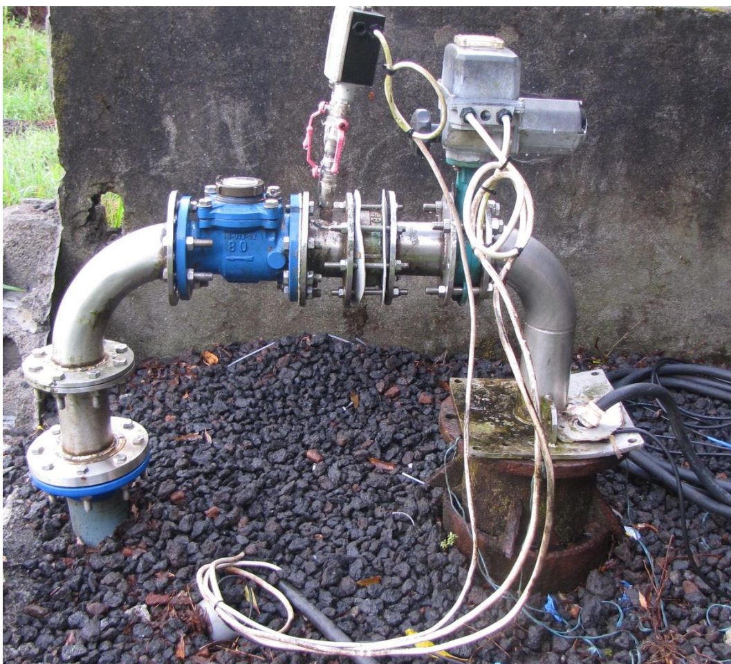
Pormenor do ponto de água.
