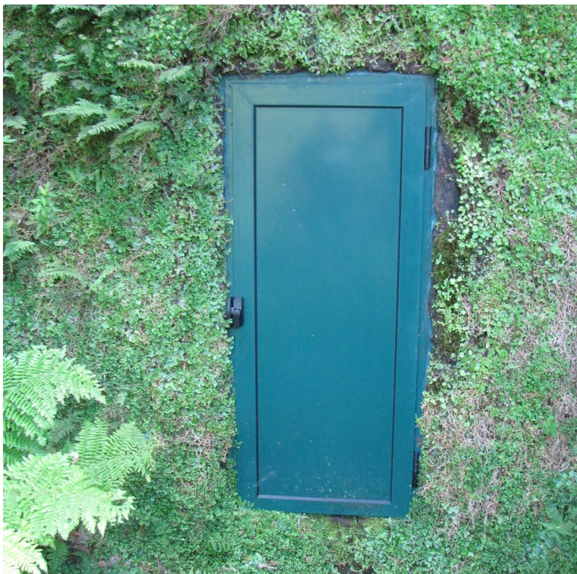
Vista geral do ponto de água.
