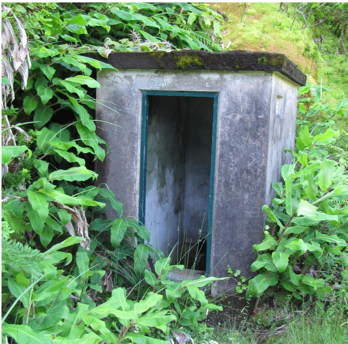
Vista geral do ponto de água.
