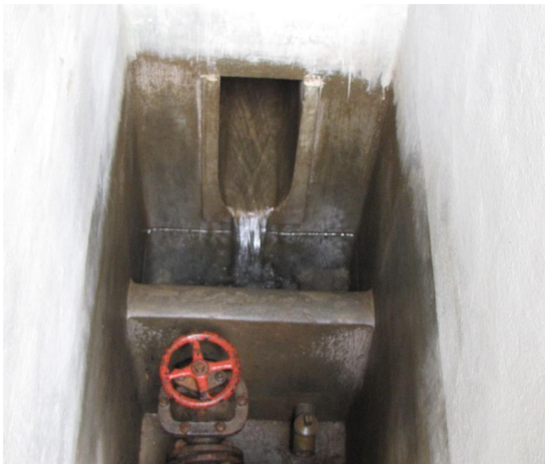
Pormenor do ponto de água.
