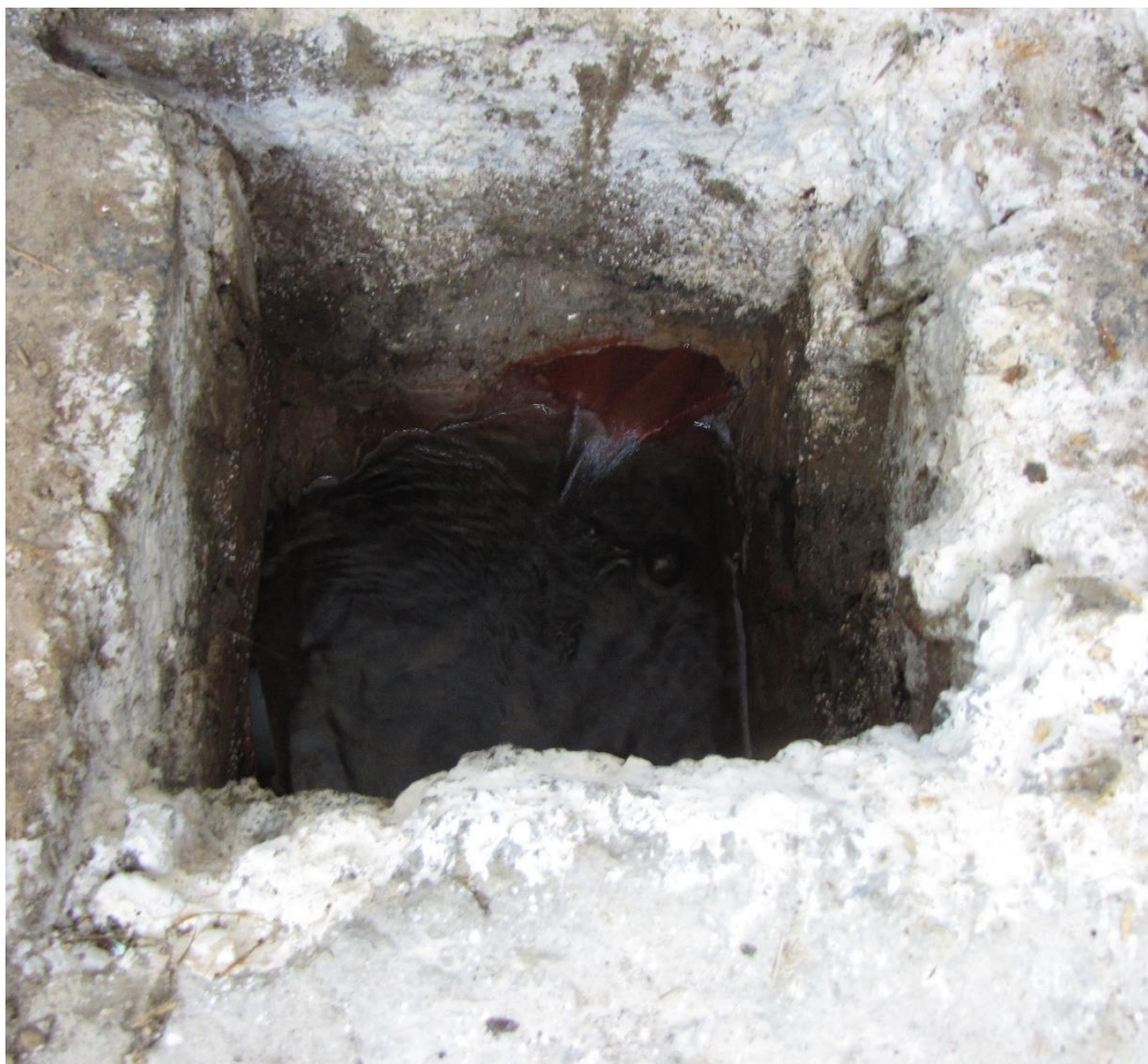
Pormenor do ponto de água.
