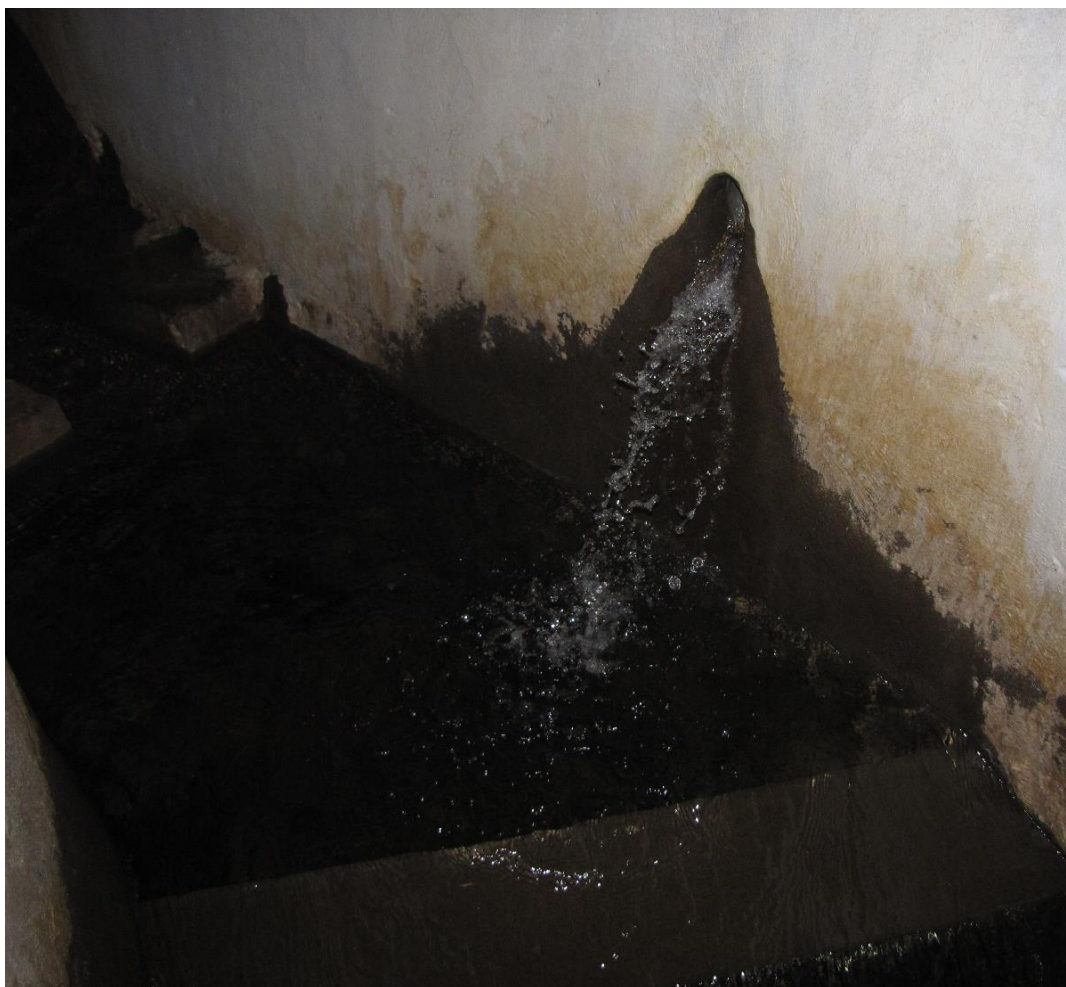
Pormenor do ponto de água.
