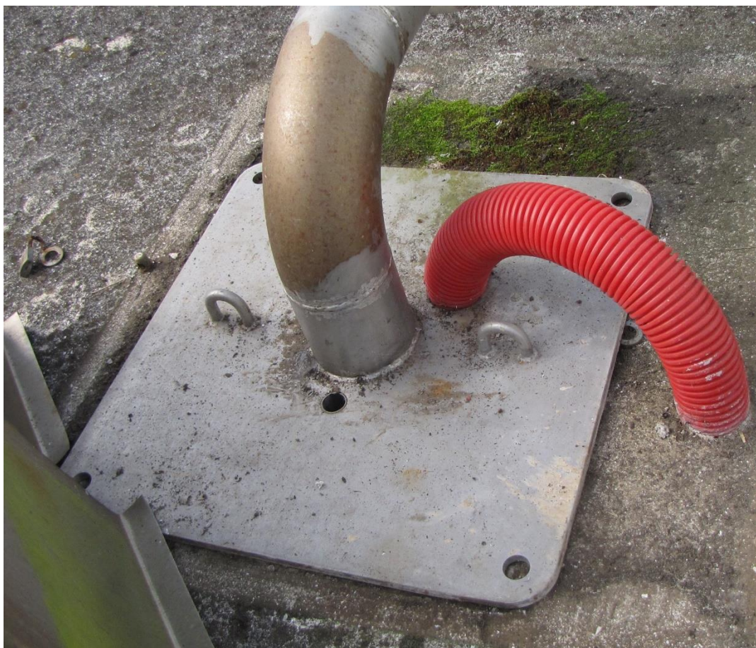
Pormenor do ponto de água.
