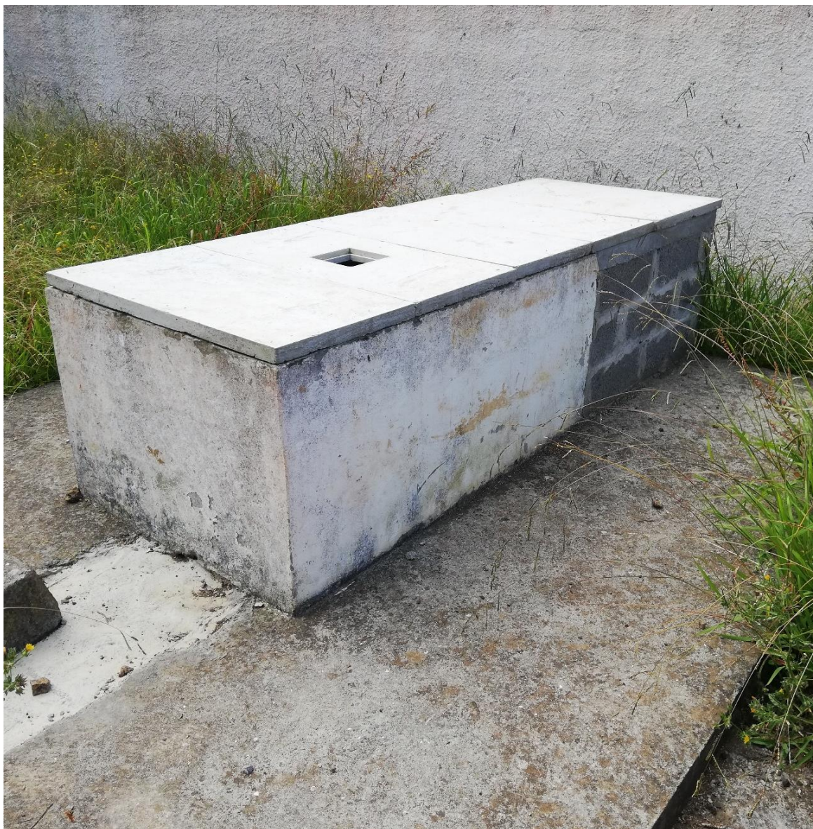
Vista geral do ponto de água.
