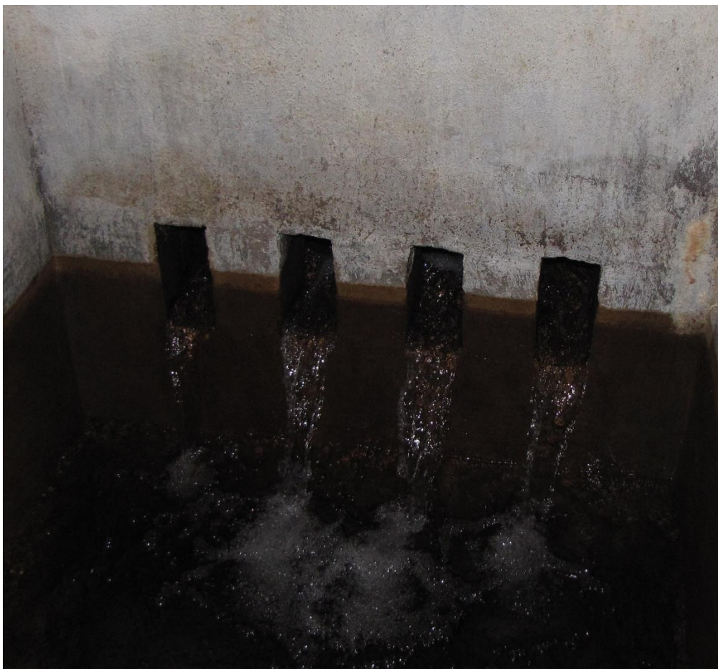
Pormenor do ponto de água.
