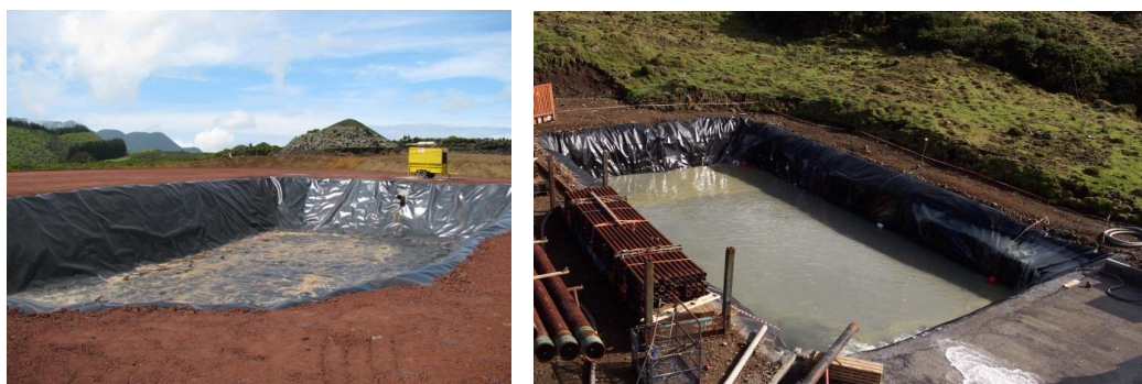
Figura 3.16 – Reservatório de rejeição de resíduos de perfuração revestido com geomembrana em PEAD (à esquerda – durante a construção da plataforma; à direita – em utilização durante a perfuração de um poço)
